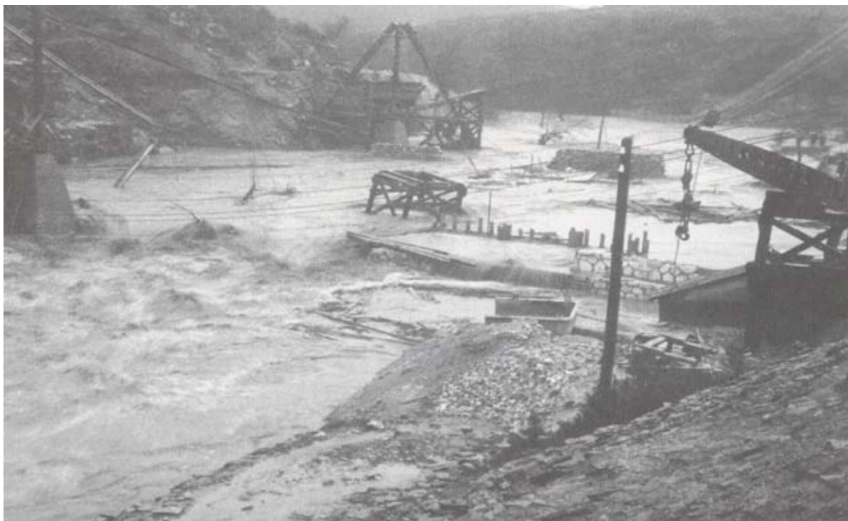
Εικ. 8.3. Υπερπήδηση προφράγματος και κατάκλυση της περιοχής θεμελίωσης του φράγματος Μαραθώνα.
