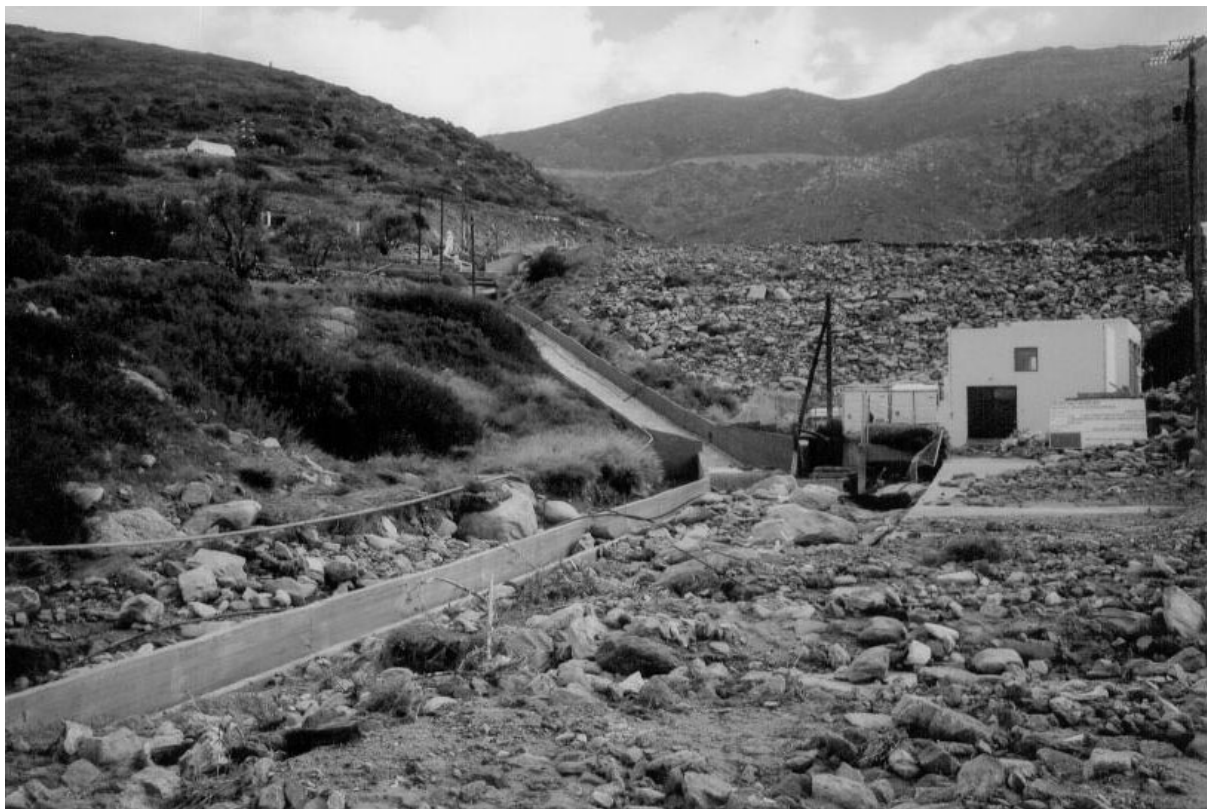
Εικ. 8.2. Κατάντη όψη φράγματος Αγίας Χανιών μετά το ατυχές συμβάν και υλικά που διαβρώθηκαν και παρασύρθηκαν.
