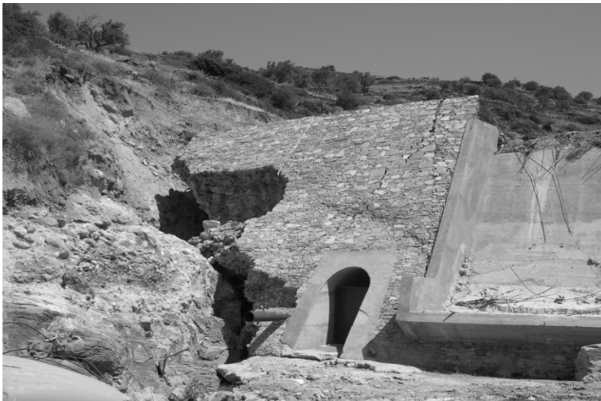
Εικ. 8.1. Κατάντη όψη του φράγματος Καμαρών Σίφνου μετά την αστοχία. Διακρίνεται η διάβρωση του δεξιού αντερείσματος, το στόμιο της στοάς πρόσβασης και τμήμα του συστήματος του υπερχειλιστή.
