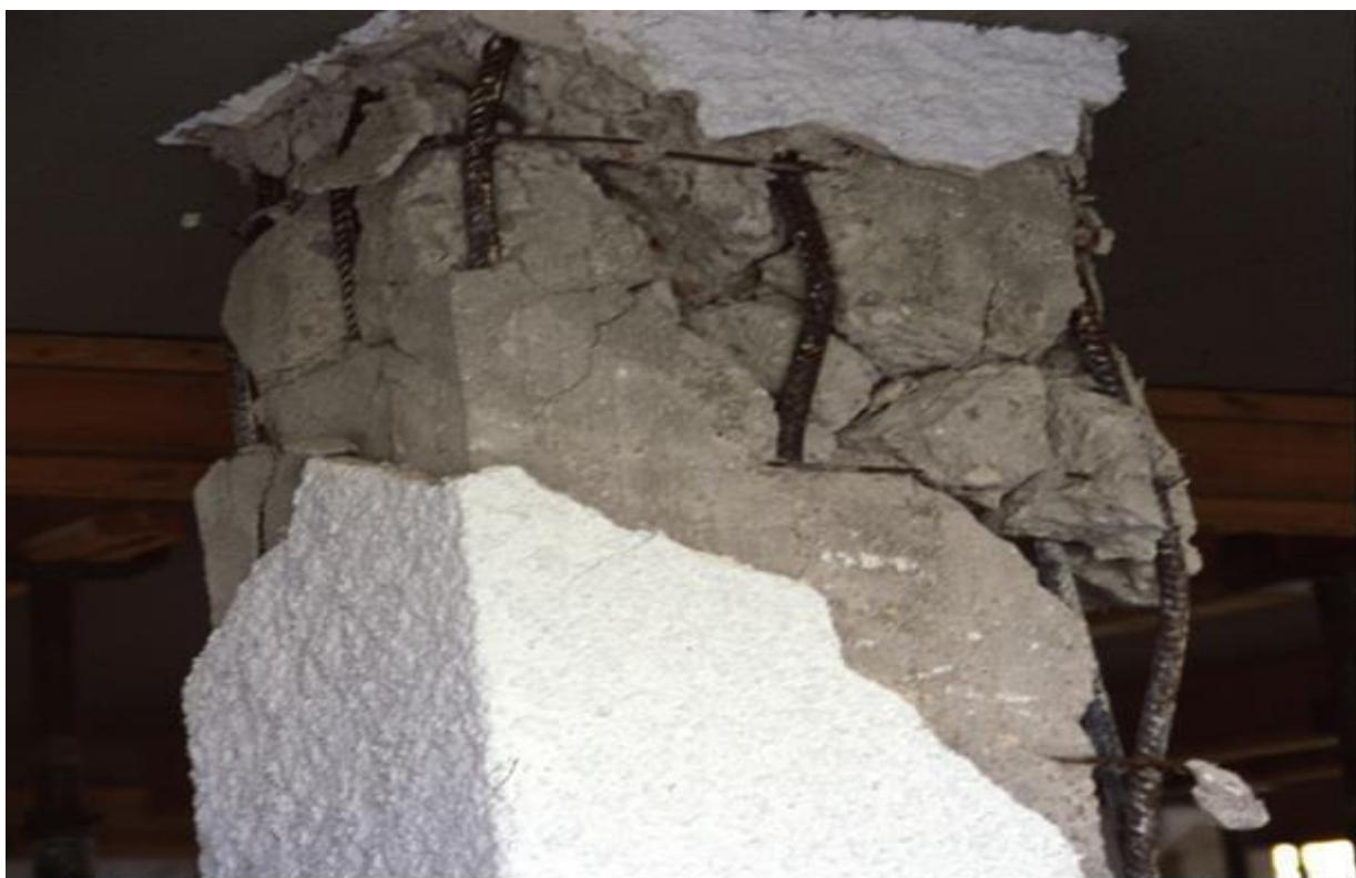
Εικόνα 4.21: Διατμητική αστοχία υποστυλώματος (Πηγή: Γιαννόπουλος Ι., 2005)
