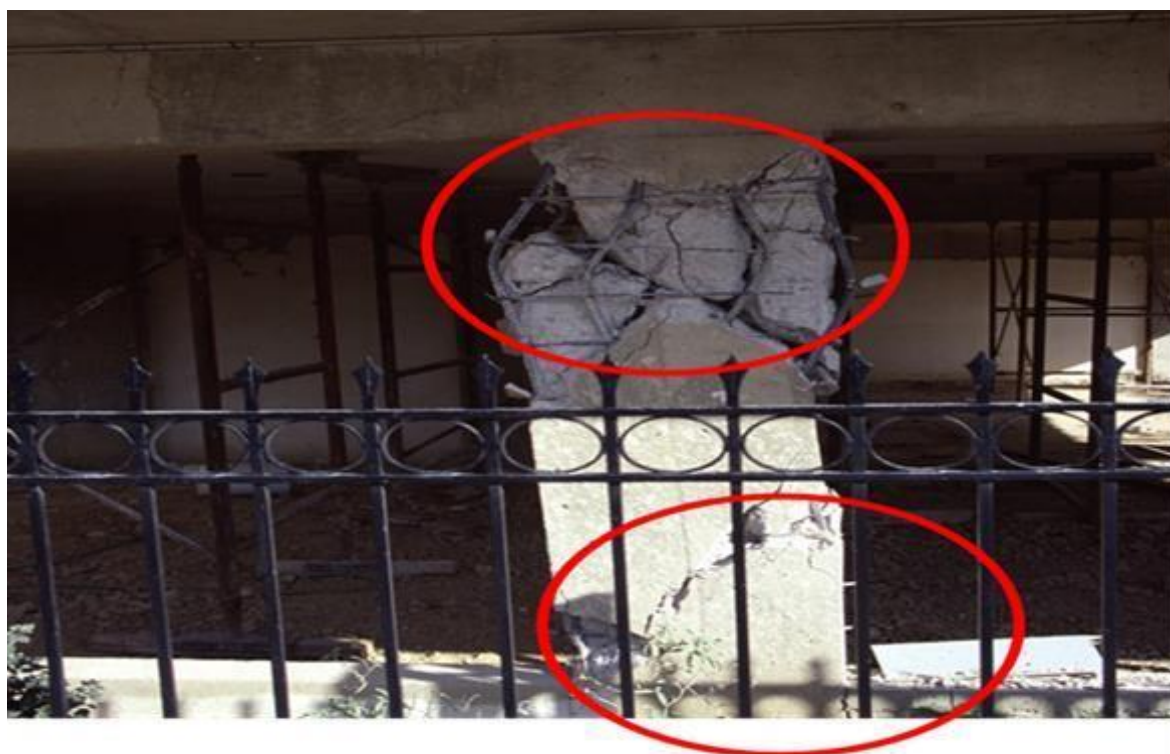
Εικόνα 4.19: Διατμητική αστοχία υποστυλώματος πάνω και κάτω με λυγισμό ράβδων (Πηγή: Γιαννόπουλος 2005)
