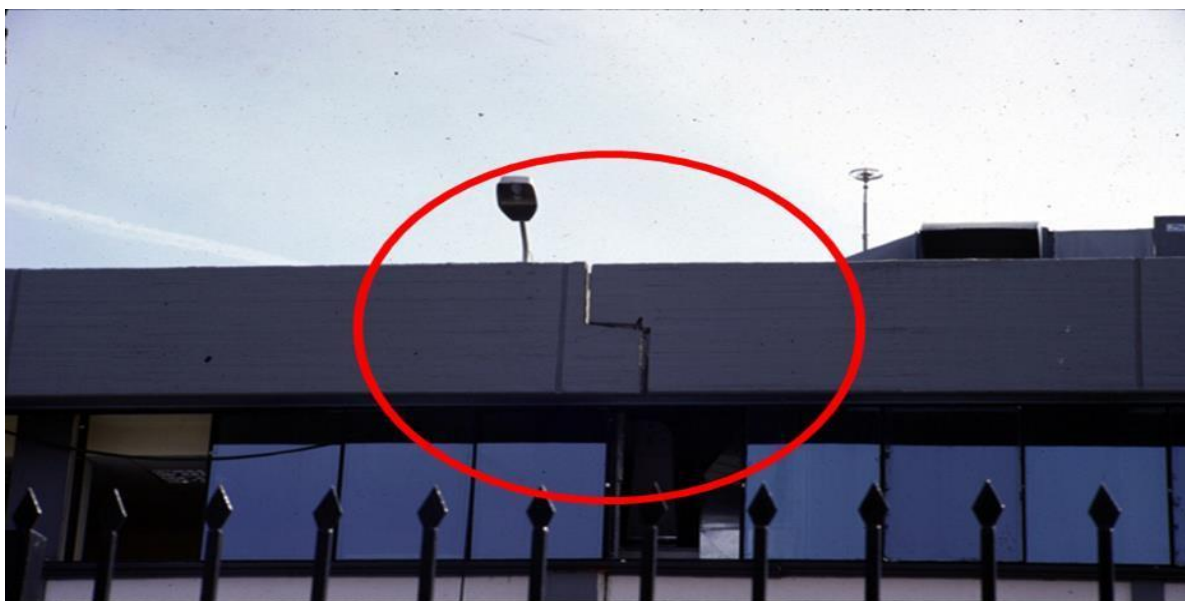
Εικόνα 3.7: Μικρό άνοιγμα αρμού διαστολής από οριζόντια σεισμική μετακίνηση σε κτίριο μεγάλης κάτοψης(Πηγή: Γιαννόπουλος Ι., 2005)
