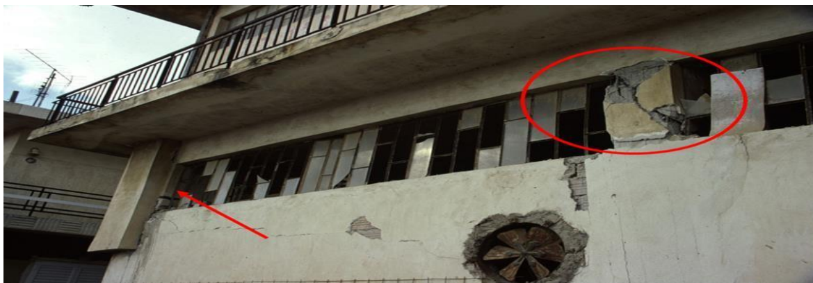
Εικόνα 4.13: Βλάβη Γ βαθμού στο κοντό υποστύλωμα που φαίνεται στον κύκλο ενώ με το βέλος διαπιστώνουμε την αποτελεσματικότητα επισκευής με τοπικό μανδύα κοντού υποστυλώματος βλαμμένου από προηγούμενο σεισμό (Πηγή: Γιαννόπουλος Ι., 2005)
