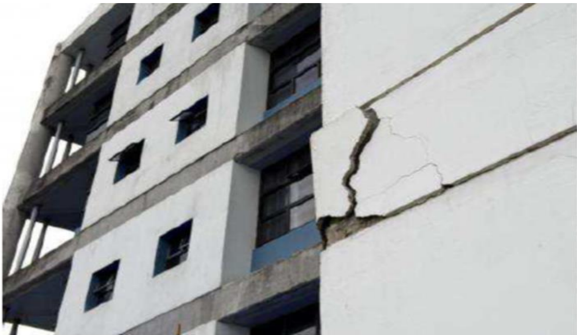
Εικόνα 4.42: Βλάβη σε τοίχωμα ενός κτιρίου λόγω σεισμού(Πηγή: Γιαννόπουλος Ι., 2005)
