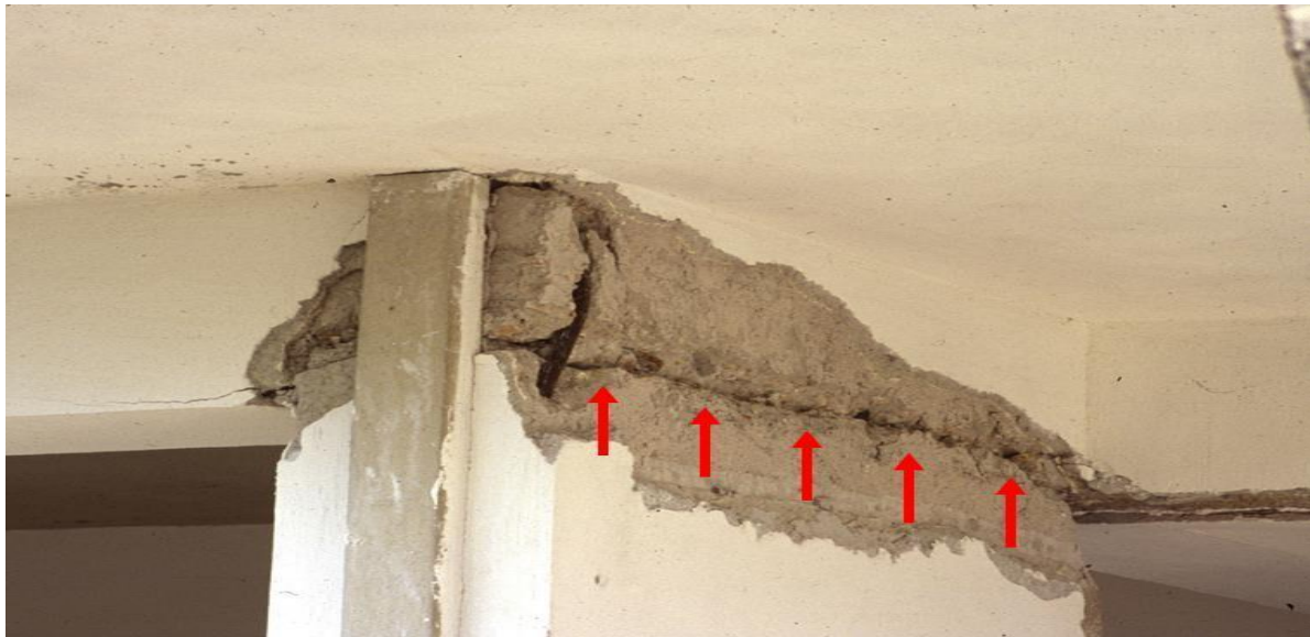
Εικόνα 4.31: Ανεπαρκής αγκύρωση κάτω ράβδων δοκού λόγω σκυροδέτησης υποστυλώματος πάνω από τη μασχάλη δοκού(Πηγή: Γιαννόπουλος Ι., 2005)
