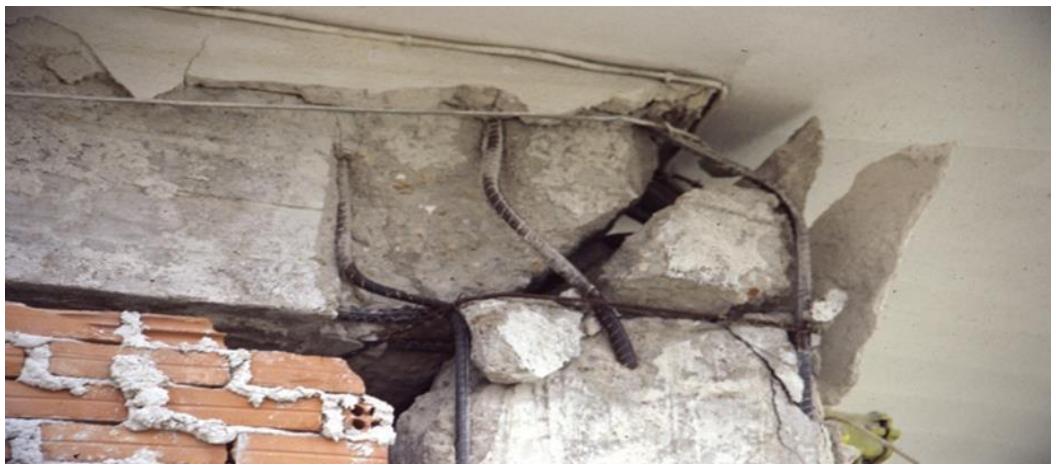
Εικόνα 4.32: Αστοχία εξωτερικού κόμβου και πρακτική απώλεια στήριξης δοκού(Πηγή: Γιαννόπουλος Ι., 2005)
