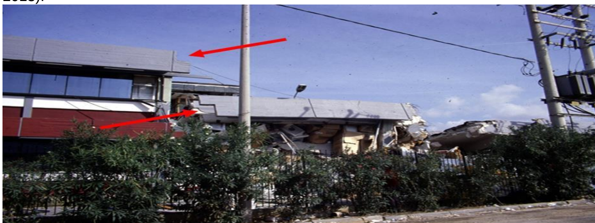
Εικόνα 3.12: Απώλεια στήριξης δοκού αρμού διαστολής λόγω μεγάλου ανοίγματος αρμού(Πηγή: Γιαννόπουλος Ι., 2005)
