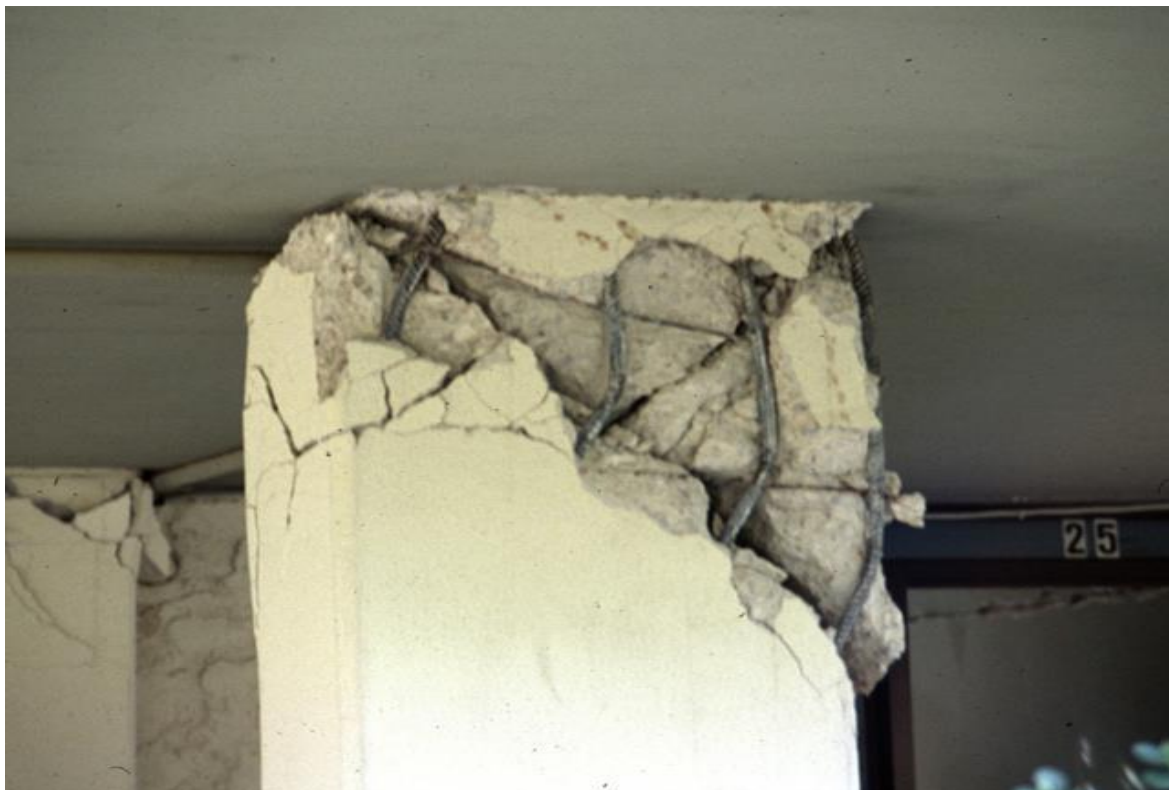
Εικόνα 4.20: Διατμητική αστοχία υποστυλωμάτων με λυγισμό ράβδων και θραύση λεπτών και αραιών συνδετήρων (Πηγή: Γιαννόπουλος Ι., 2005)
