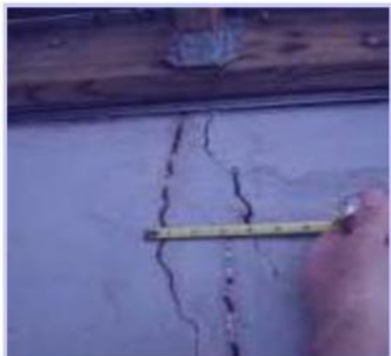
Εικόνα 4.15: Βλάβη σε κτίριο λόγω θεμελίωσης (Πηγή: Γιαννόπουλος Ι., 2005)
