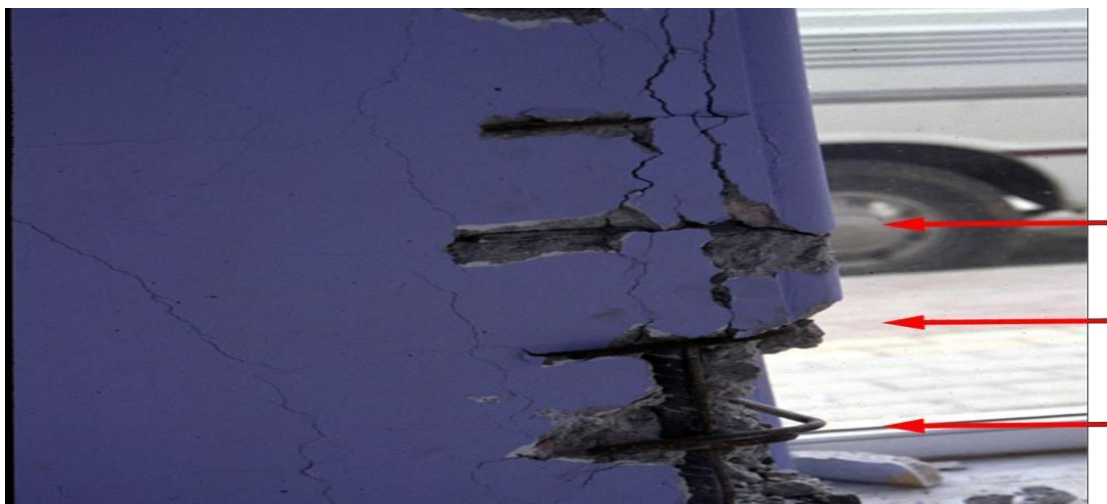
Εικόνα 4.17: Εκτίναξη γωνίας διατομής σκυροδέματος λόγω μη συγκράτησης του κατακόρυφου οπλισμού στη γωνία συνδετήρα(Πηγή: Γιαννόπουλος Ι., 2005)
