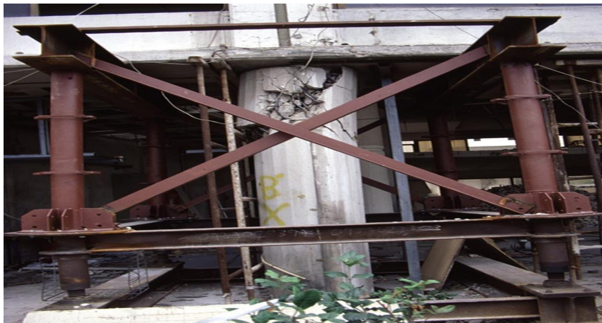
Εικόνα 4.23: Διατμητική αστοχία υποστυλώματος πάνω & κάτω με λυγισμό ράβδων (Πηγή: Γιαννόπουλος Ι., 2005)
