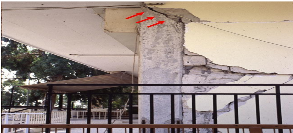
Εικόνα 4.34: Διαγώνια ρηγμάτωση εξωτερικού κόμβου(Πηγή: Γιαννόπουλος Ι., 2005)
