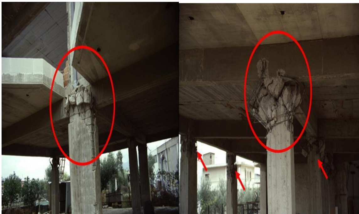
Εικόνα 4.24: Διατμητική αστοχία πάνω άκρου υποστυλωμάτων λόγω απουσίας συνδετήρων. Ο μανδύας συνδετήρων έφτανε μέχρι 0.50 m κάτω από τις δοκούς(Πηγή: Γιαννόπουλος Ι., 2005)
