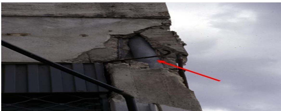
Εικόνα 4.35: Αστοχία κόμβου και απώλεια περίσφιγξης συνδετήρων λόγω τοποθέτησης υδρορροής εντός του υποστυλώματος(Πηγή: Γιαννόπουλος Ι., 2005)
