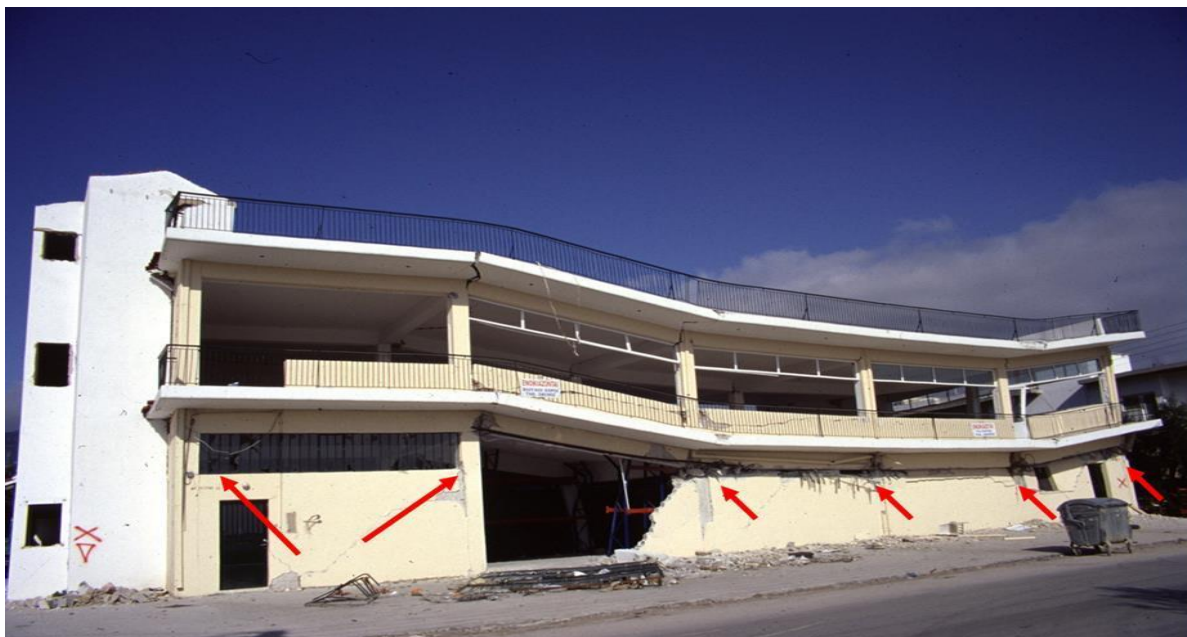
Εικόνα 3.5: Αστοχία σειράς κοντών υποστυλωμάτων(Πηγή: Γιαννόπουλος Ι., 2005)
