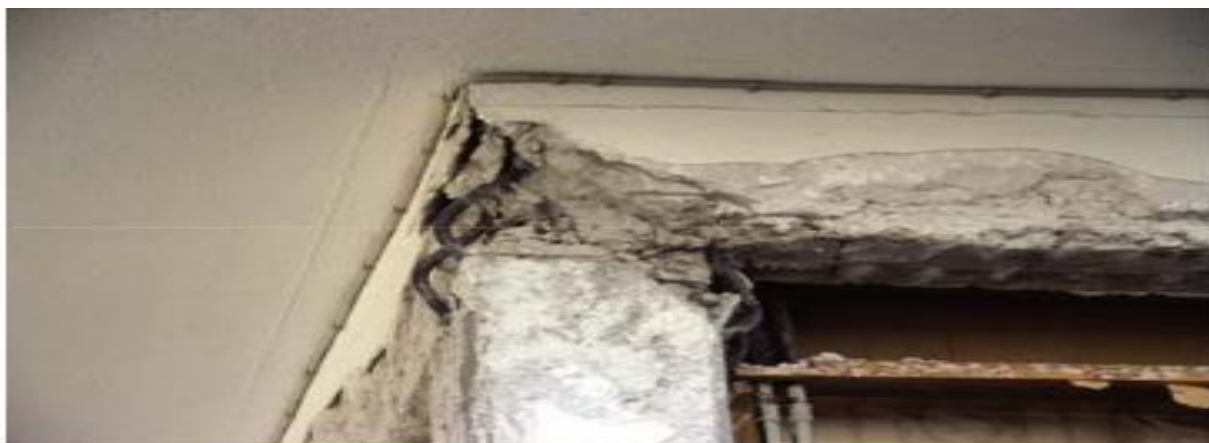
Εικόνα 3.9: Αστοχία εξωτερικού κόμβου με μείωση ακαμψίας του ((Πηγή: Γιαννόπουλος Ι., 2005)
