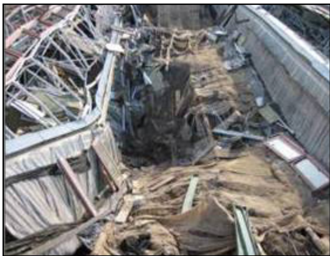
Εικόνα 15: Το τμήμα του στεγάστρου που κατέρρευσε το 2005
