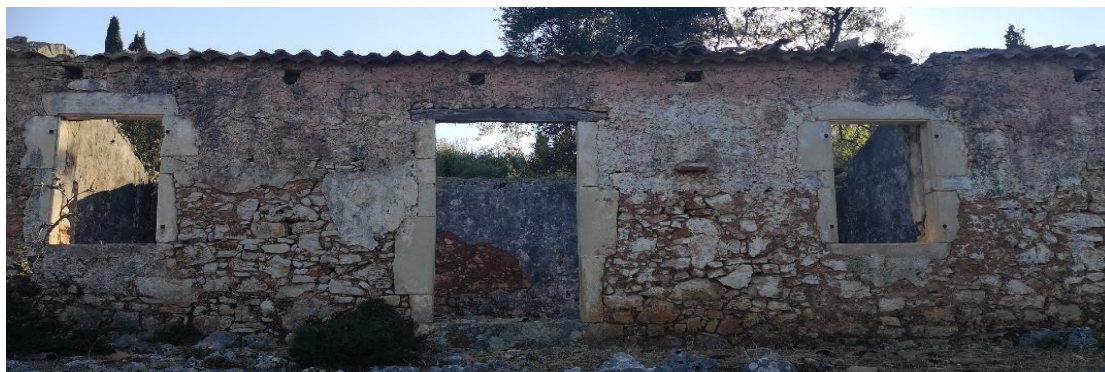
Εικόνα 90. Πρόσοψη οικίας στα Λαταθινάτα με υπολείμματα κεραμιδιών από την στέγη που έχει καταρρεύσει.
