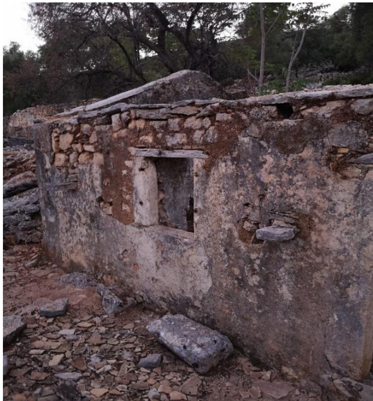
Εικόνα 88. Τοιχοποιία με διαμπερή ρωγμή και κατάρρευση μέρους της. Πηγή : προσωπικό αρχείο
