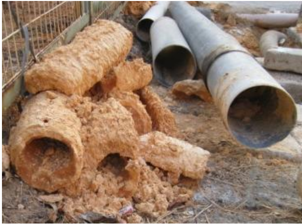
Εικ. Δ.2.11. Υλικό πλήρωσης σωληνώσεων (χρώματος πορτοκαλί).
