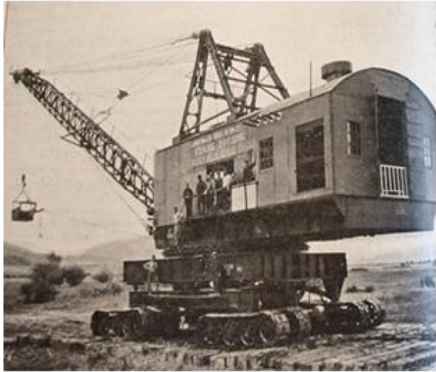
Εικόνα 279. Από τα έργα των πεδιάδων Σερρών και Δράμας. Εκσκαφέας Dragline χωρητικότητας κάδου 4 κυβικών υάρδων. 1 Φεβρουαρίου 1932.
