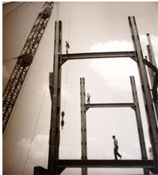
Εικόνα 141. Ατμοηλεκτρικός Σταθμός Πτολεμαΐδας. 1964. Φωτογραφικό αρχείο ΔΕΗ.
