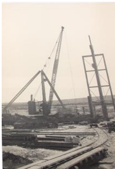
Εικόνα 150. Από την κατασκευή του κεντρικού ατμοηλεκτρικού σταθμού Αγίου Γεωργίου στο Κερατσίνι. 23 Αυγούστου 1926. Φωτογραφικό αρχείο ΗΕΑΠ.
