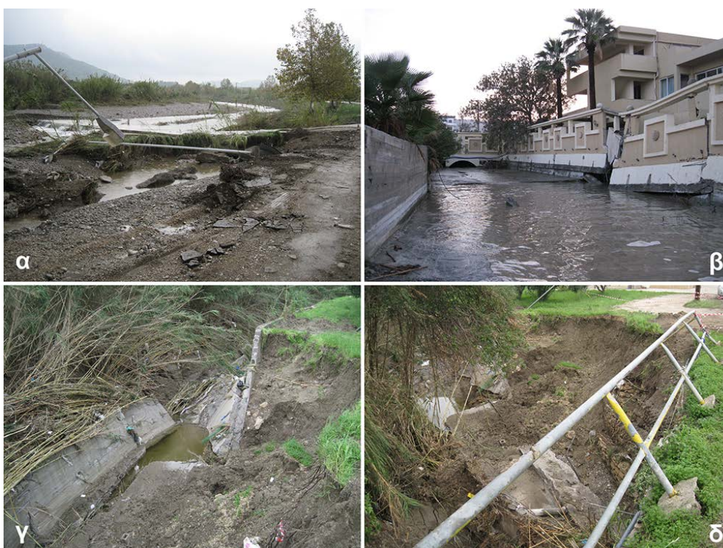
Εικ. 4. 4 Παραδείγματα διάβρωσης του εδαφικού υλικού από την περιοχή της Ιαλυσού και της Κρεμαστής από την πλημμύρα του Νοεμβρίου 2013.
