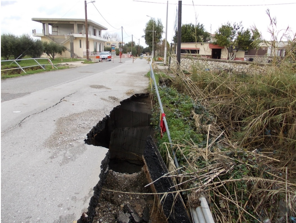
Εικ. 6. 4 Εκτεταμένες ζημιές στο κατάστρωμα, και τη βάση στήριξης γέφυρας στην περιοχή της Κρεμαστής, οι οποίες οδήγησαν στην ολική ακύρωση της λειτουργίας της συγκεκριμένης υποδομής και επομένως στην ανάγκη ολικής επανασχεδίασής της.
