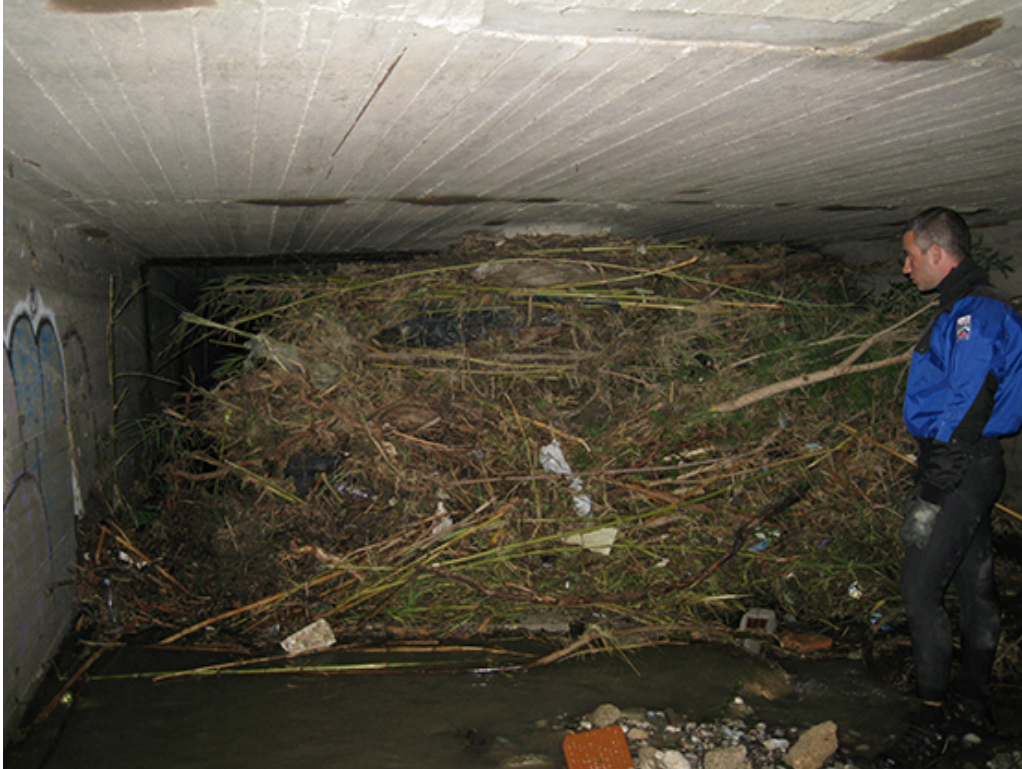
Εικ. 6. 15 Συσσώρευση θραυσμάτων βλάστησης στην είσοδο του πλακοσκεπή αγωγού της Ιαλυσού
