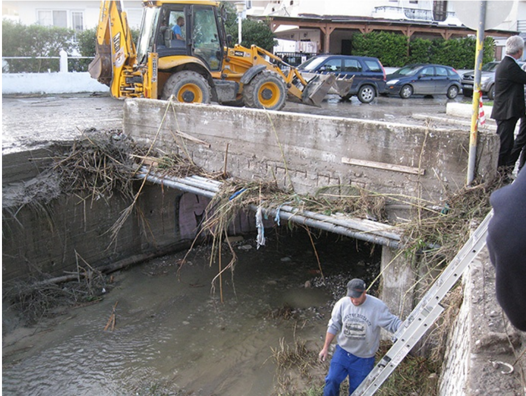
Εικ. 6. 14 Η ανάντη πλευρά του πλακοσκεπή αγωγού κατασκευασμένος επί του κυρίου ρέματος της Ιαλυσού
