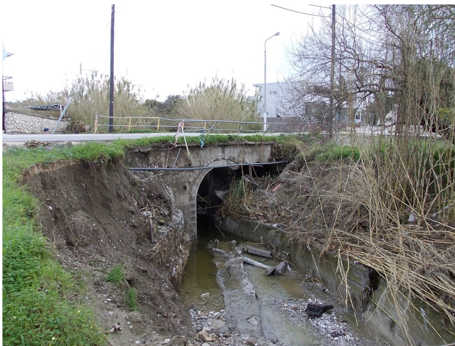
Εικ. 4. 5 Κατάρρευση γέφυρας στην περιοχή της Παστίδας κατά την πλημμύρα του Νοεμβρίου 2013, λόγω υποσκαφής που προήλθε από την διάβρωση των πρανών της κοίτης του εν λόγω ρέματος.
