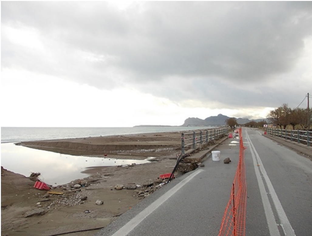
Εικ. 6. 3 Παράδειγμα γέφυρας στην Αφάντου, η οποία υπέστη κατάκλυση κατά τη διάρκεια των πλημμυρών του Ιανουαρίου 2014 και περιορισμένες ζημιές στα κιγκλιδώματα.
