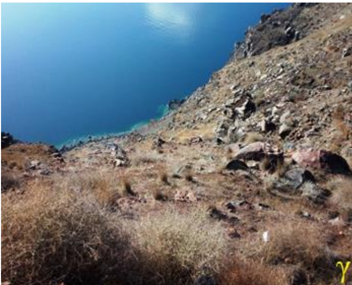
Εικόνα 29: α), β) Μεγάλες και βαθιές ρωγμές που παρατηρούνται στα τσιμεντένια σκαλοπάτια καθόδου στο Σκάρο, γ) άποψη της κατολισθαίνουσας προς τη θάλασσα πλαγιάς.
