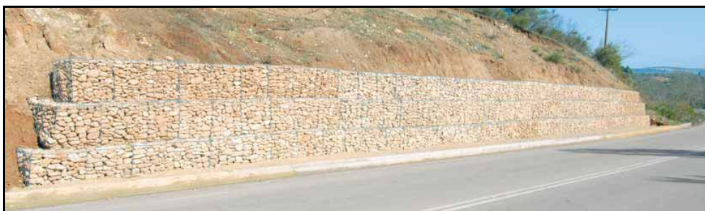
Εικόνα 5.6: Συρματοκιβώτια με υδροπερατά υλικά για την αντιστήριξη και αποστράγγιση κατολισθαίνοντος πρανούς στο δρόμο Αταλάντης – Καλαποδίου.
