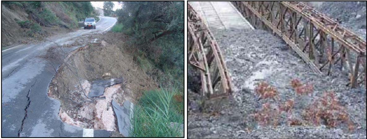
Εικόνες 5.3 & 5.4: Κατολίσθηση στον κεντρικό δρόμο στην είσοδο του Πύργου Υπάτης, και δεξιά στο δρόμο Γαρδικίου – Στάγιας στο σημείο της γέφυρας της Βίστριζας (Πηγή: URL 5.3 & 5.4).
