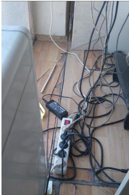
Εικόνα 6-6 Ακάλυπτα καλώδια στη θέση εργασίας τα οποία μπορεί να προκαλέσουν προβλήματα στον εργαζόμενο.
