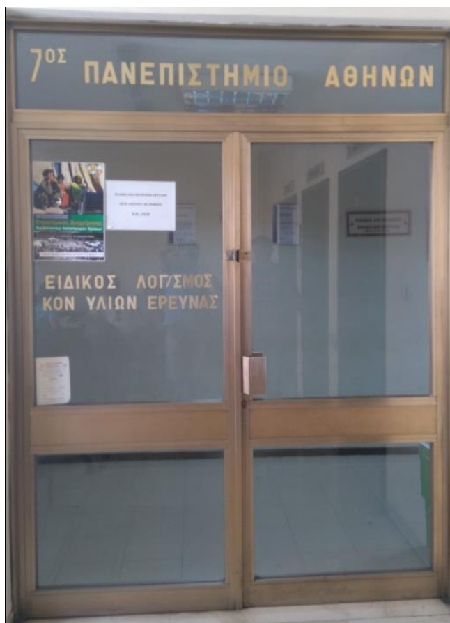
Εικόνα 6-5 Οι σιδερένιες πόρτες στην είσοδο κάθε όροφο δεν παρέχουν καμία ασφάλεια στους εργαζόμενους καθώς δεν είναι από πυράντοχο υλικό και δεν ανοίγουν προς τη φορά εξόδου.
