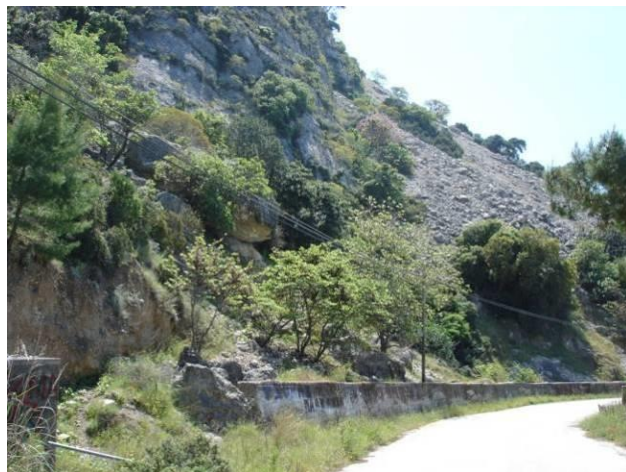
Σχήμα 5.32: Κατολισθήσεις/ τοιχείο από οπλισμένο σκυρόδεμα \pi=30\text{cm} h=1.30 μήκος= 100 μ Ανθρακικός σχηματισμός και κορήματα. (417097, 4211617 alt.=12m).
