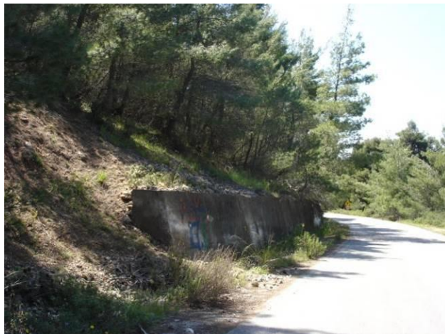
Σχήμα 5.33: Τοιχείο από οπλισμένο σκυρόδεμα για προστασία του δρόμου από κατολισθήσεις \pi=85 cm h=2 μ μήκος=50μ (411090, 4209806 alt.= 451m).
