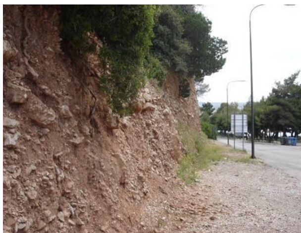
Σχήμα 5.34: Κίνδυνος κατολισθήσεων . Βρισκόμαστε ακριβώς έξω από το κέντρο του Λουτρακίου στο δρόμο προς Περαχώρα. Περίπου 80^\circ κλίση (409045, 4204315 el.6).
