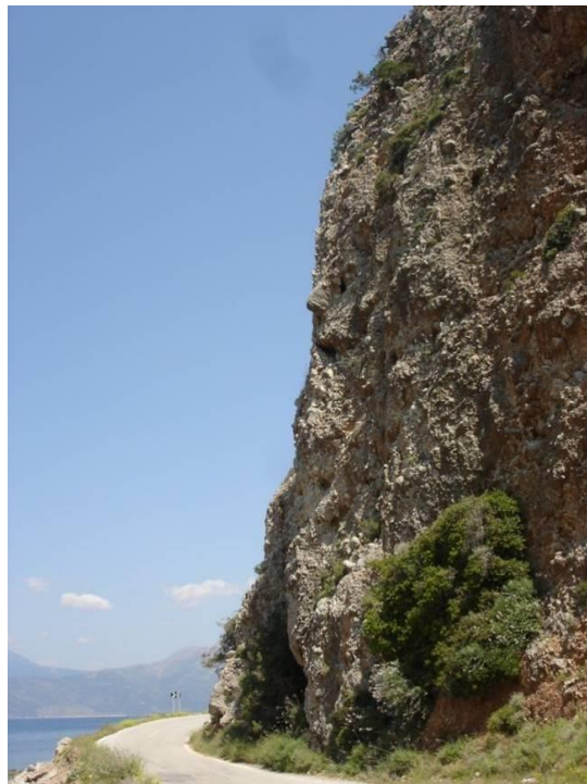
Σχήμα 5.25: Σαθρό έδαφος- κατολισθήσεις. Κατακερματισμένος σχηματισμός που έχει ολισθήσει μέχρι την κάτω πλευρά του δρόμου. Αποτελείται από διαφορετικά τεμάζια κ ίσως να είναι διάπλαση. (423880, 4213110 alt.= 8).
