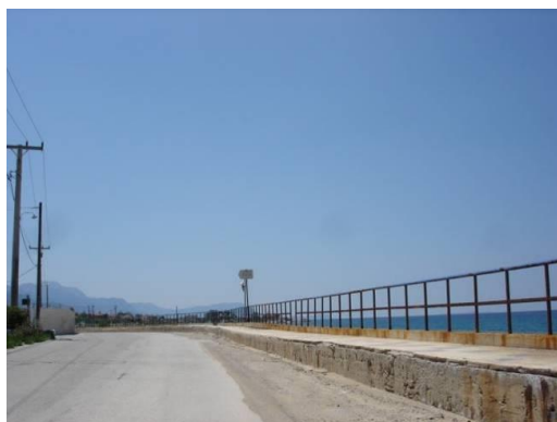
Σχήμα 5.20: Κακή ποιότητα κατασκευής με κίνδυνο καθίζησης του οδοστρώματος (429545, 4215940 el.4m).
