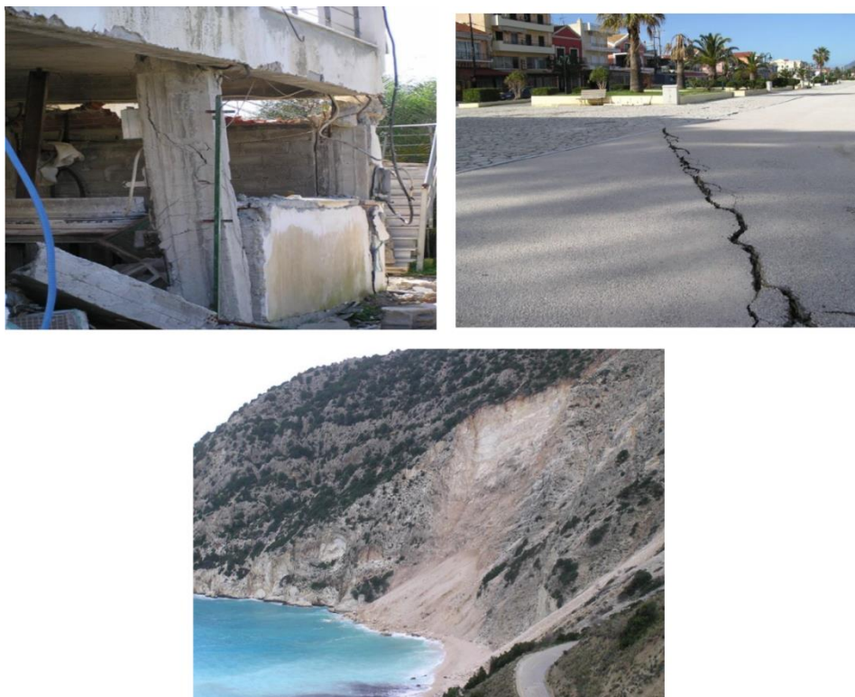
Εικόνα 5.10: Κατεστραμμένη διώροφη κατασκευή μετά από τον δεύτερο μεγάλο σεισμό (πάνω αριστερά), επιφανειακή διάρρηξη μετά τον πρώτο μεγάλο σεισμό (πάνω δεξιά) και εκτεταμένη κατολίσθηση στην παραλία του Μύρτου (κάτω) (Paradopoulos et al., 2014).
