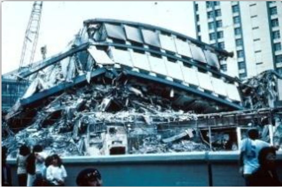
Εικόνα 2.9. Καταστροφές στο συγκρότημα διαμερισμάτων Pino Suárez, στο Mexico City μετά το σεισμό. Πηγή: ("File:1985 Mexico Earthquake - Pina Suarez Apartment Complex.jpg - Wikimedia Commons," n.d.)
