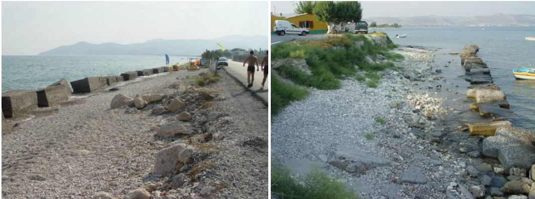
Εικόνες 26. Ενδεικτικά παραδείγματα παράκτιας διάβρωσης. Στις φωτογραφίες φαίνεται η οπισθοχώρηση των ακτών στην βορειοανατολική Σάμο
