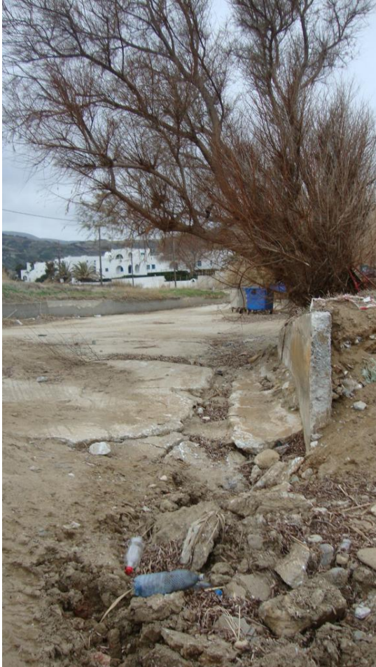
Φωτογραφία 17: Το ρέμα που καταλήγει στην παραλία. Εμφανής είναι η καταστροφή στην κατασκευή, που είχε γίνει για τη διεύθετησή του
