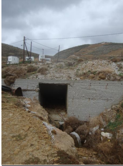
Φωτογραφία 37: Ανθρωπογενής παρέμβαση προκειμένου να διευθετηθεί η κοίτη και να περάσει ο δρόμος, όπου αποτελεί τον κύριο οδικό άξονα που πηγαίνει προς τη Χώρα
