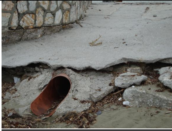
Φωτογραφία 33: Αγωγός λυμάτων που καταλήγει στη θάλασσα
