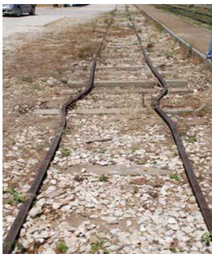
Φωτογραφία 3.26: Οριζόντια μετατόπιση σιδηροδρομικών γραμμών λόγω εδαφικών διαρρήξεων στην Κάτω Αχαΐα (Μανρουλίσ et al., 2010)
