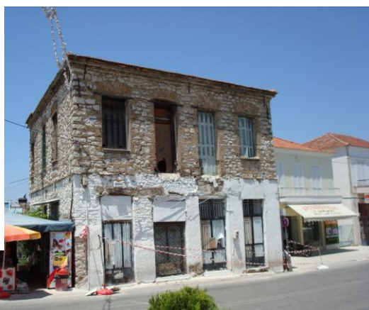
Φωτογραφίες 3.17 και 3.18: Διώροφο κτίσμα με εμφανείς τις ανγκυρώσεις των ελκυστήρων. Εκτός από την πτώση του εξωτερικού προβόλου στον 1 ο όροφο δεν παρατηρήθηκαν άλλες βλάβες στη φέρουσα λιθοδομή (Φ.Α. Φ. Διαμαντόπουλου)
