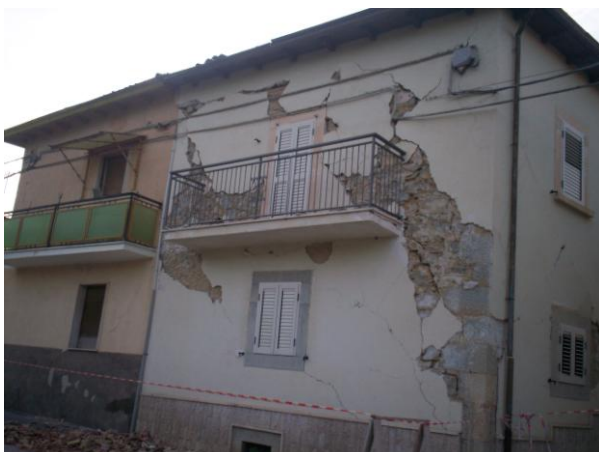
Φωτογραφία 6.9: Διαμπερείς ρηγματώσεις σε δώροφη κατοικία
