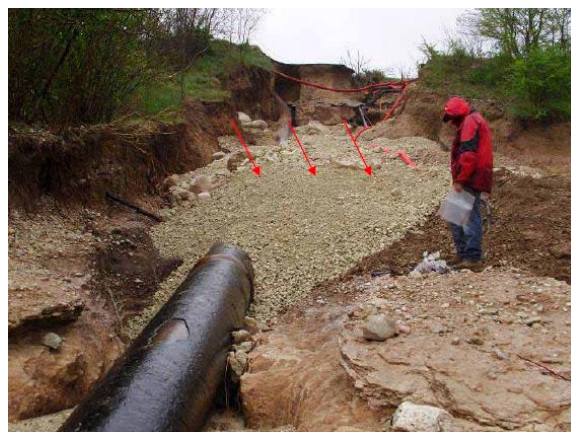
Φωτογραφία 6.34: Ο σπασμένος αγωγός ύδρευσης. Το σημείο της διάρρηξης τονίζεται με τα κόκκινα βέλη (Blumetti et al., 2009)
