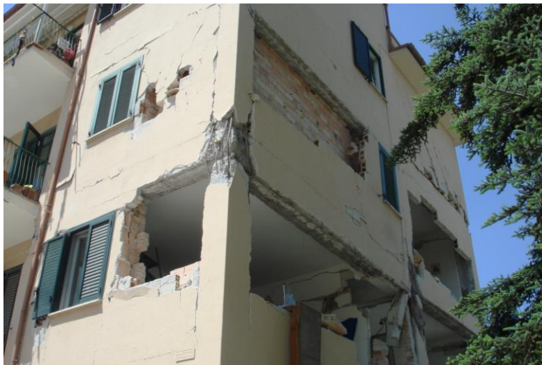
Φωτογραφία 6.24: Κατάρρευση τοιχοπληρώσεων, θραύση κόμβου με αποκάλυψη και παραμόρφωση οπλισμού (Φ.Α. Β. Αγιάνογλου)
