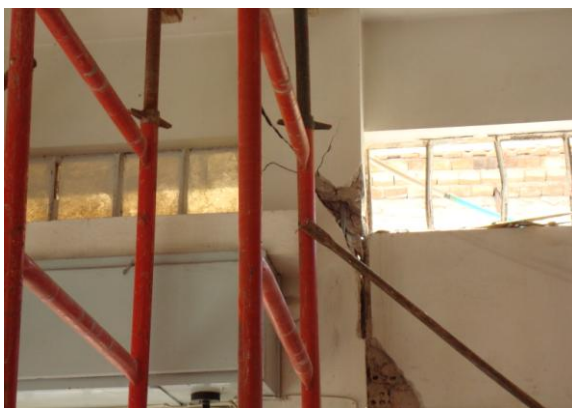
Φωτογραφία 3.23: Υποσύλωση οροφής λόγω θραύσης υποστυλωμάτων
