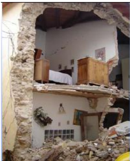
Φωτογραφία 6.17: Κατάρρευση διώροφης κατοικίας με πλάκα ορόφου από Ο/Σ (Manfredi, 2010)
