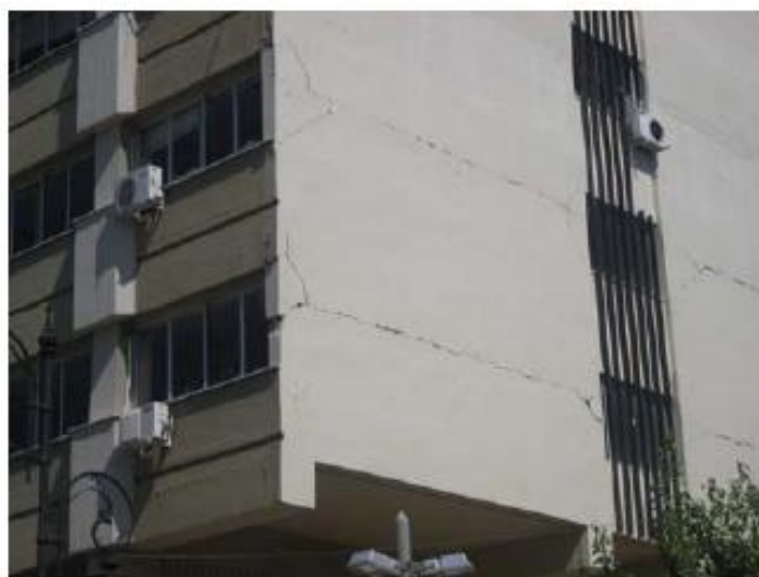
Φωτογραφία 3.25: Εκτεταμένες ρηγματώσεις στο κτίριο της Νομαρχίας στον Πύργο (Ι.Τ.Σ.Α.Κ., 2008)
