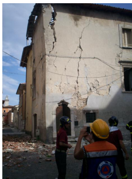
Φωτογραφία 6.12: Ρηγματώσεις και αποκλίσεις σε τριώροφο κτίσμα (Φ.Α. Β. Αγιάνογλου)
