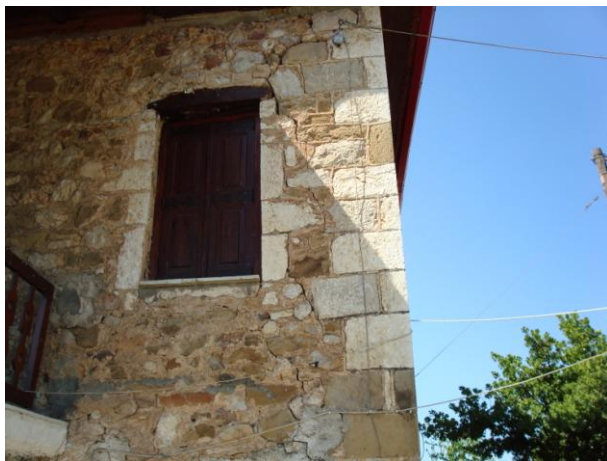
Φωτογραφία 3.3: Διαμπερή ρωγή σε δώροφη κατοικία με γωνιόλιθους
