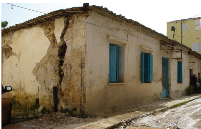
Φωτογραφία 3.1: Διαμπερείς ρωγμές και απόκλιση φέρουσας λιθοδομής στην Αμαλιάδα (Φωτογραφικό Αρχείο Γ. Ζάγορα)
