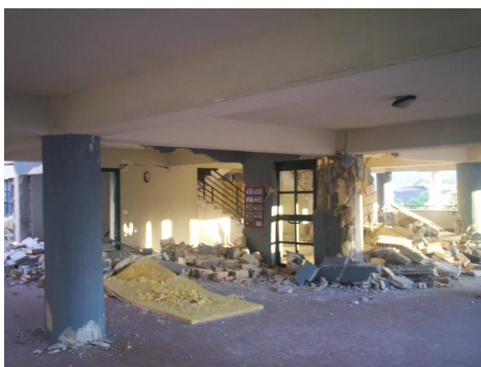
Φωτογραφία 6.21: Θραύση κάθετων στοιχείων και αποκάλυψη οπλισμού (Φ.Α. Β. Αγιάνογλου)
