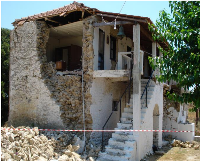
Φωτογραφία 3.7: Κατάρρευση περιμετρικής λιθοδομής με προσθήκες εξωτερικών στοιχείων Ο/Σ σε διώροφο κτίσμα μονής στην Ηλεία
