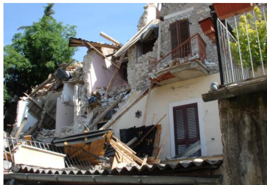
Φωτογραφία 6.10: Κατάρρευση κατοικίας
