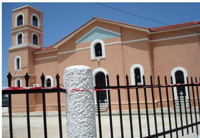
Φωτογραφία 3.21: Μετατόπιση κωδωνοστασίου. Το υπόλοιπο κτίσμα δεν παρουσίασε βλάβες. (Φ.Α. Φ. Διαμαντόπουλου)
