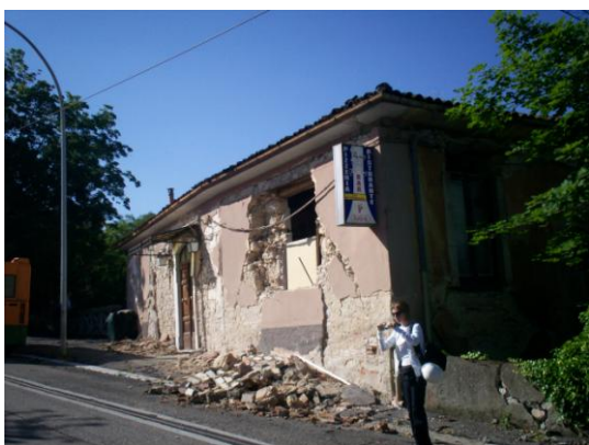
Φωτογραφία 6.15: Μερική κατάρρευση κτίσματος. Η στέγη στηρίζεται πάνω σε πλάκα Ο/Σ που εδράζεται στη λιθοδομή (Φ.Α. Β. Αγιάνογλου)
