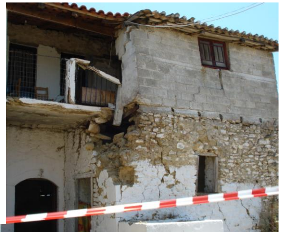
Φωτογραφία 3.8: Παραμόρφωση και απόκλιση περιμετρικής λιθοδομής και της νεώτερης προσθήκης στον όροφο του ίδιου κτίσματος (Φ.Α. Γ. Ζάγορα)
