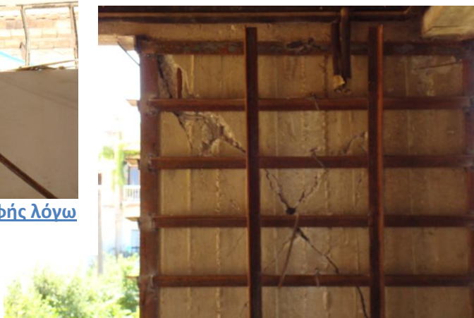
Φωτογραφία 3.24: Ρηγματώσεις σε κατακόρυφο στοιχείο και υποσύλωση με σιδηρές διατομές περίσφιξης (Φ.Α. Φ. Διαμαντόπουλου)
