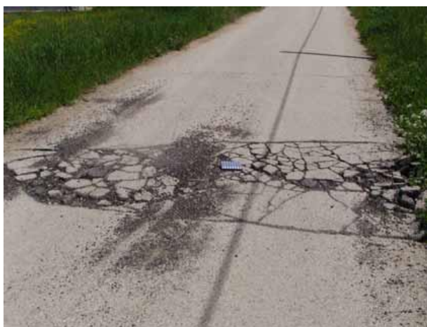
Φωτογραφία 6.33: Εδαφικές διαρρήξεις σε δρόμο που οδηγεί σε γέφυρα του ποταμού Aterno κοντά στο χωριό Fossa
