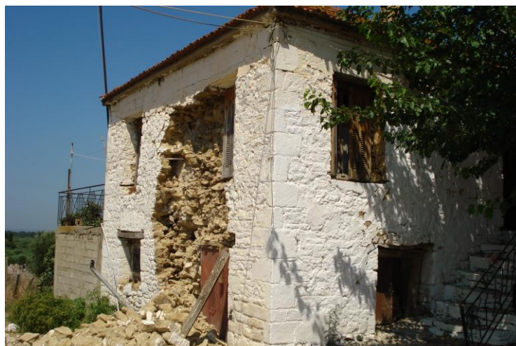
Φωτογραφία 3.10: Αποδιοργάνωση λιθοδομής σε κατοικία με εξωτερική προσθήκη (Φ.Α. Γ. Ζάγορα)
