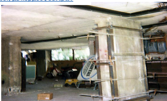
Φωτογραφία 2.2: Υποστύλωση με σιδηρές διατομές για την περίσφιξη κατακόρυφου στοιχείου (Φωτογραφικό Αρχείο Υ.Α.Σ.)
