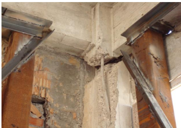
Φωτογραφία 3.22: Θραύση κόμβου σε υποσύλωμα με ελλiptή οπλισμό και απουσία συνδετήρων
