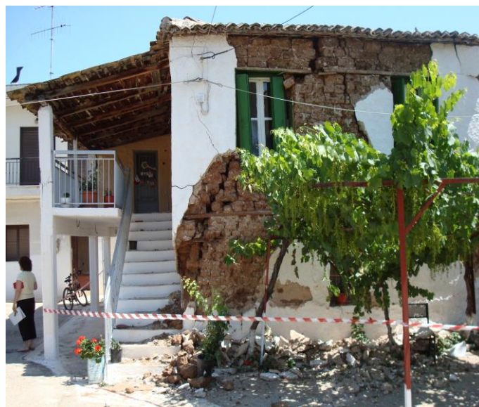
Φωτογραφία 3.9: Διαμπερείς ρωγμές, και αποκλίσεις σε διώροφη κατοικία με προσθήκη εξωτερικών στοιχείων από Ο/Σ στην Αχαΐα (Φ.Α. Φ. Διαμαντόπουλου)
