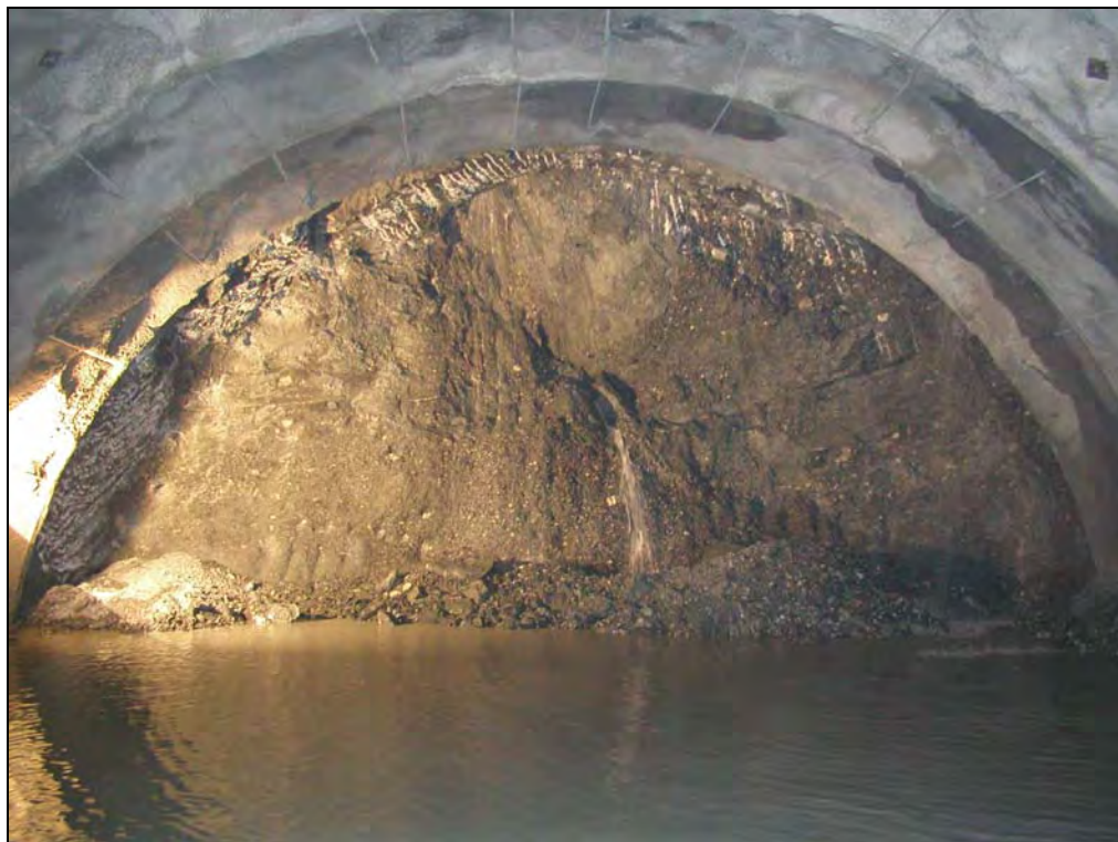
Φωτογραφία 6-22 Εισροή υδάτων στο μέτωπο διάνοιξης (24/7/2003)
