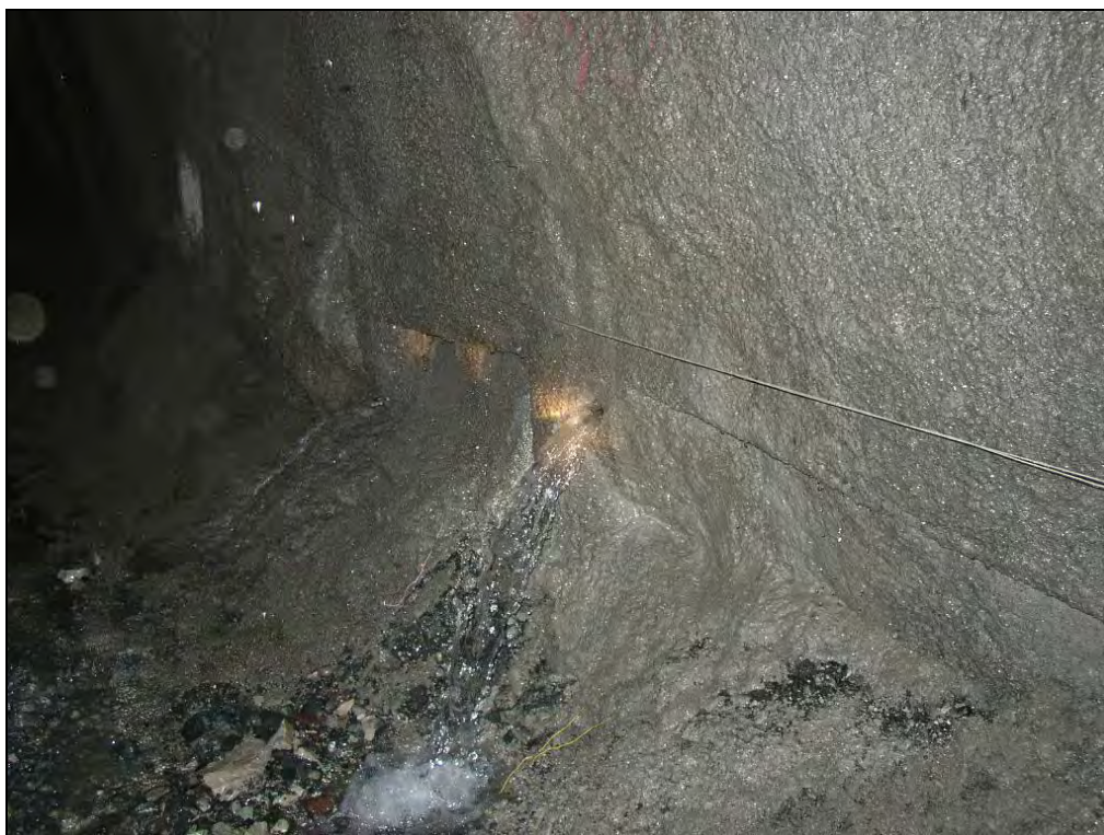
Φωτογραφία 6-25 Συνέχισης εισροής υδάτων εντός της σήραγγας ακόμα και μετά από την ολοκλήρωση των μέτρων προσωρινής αντιστήριξης (30/07/2003)
