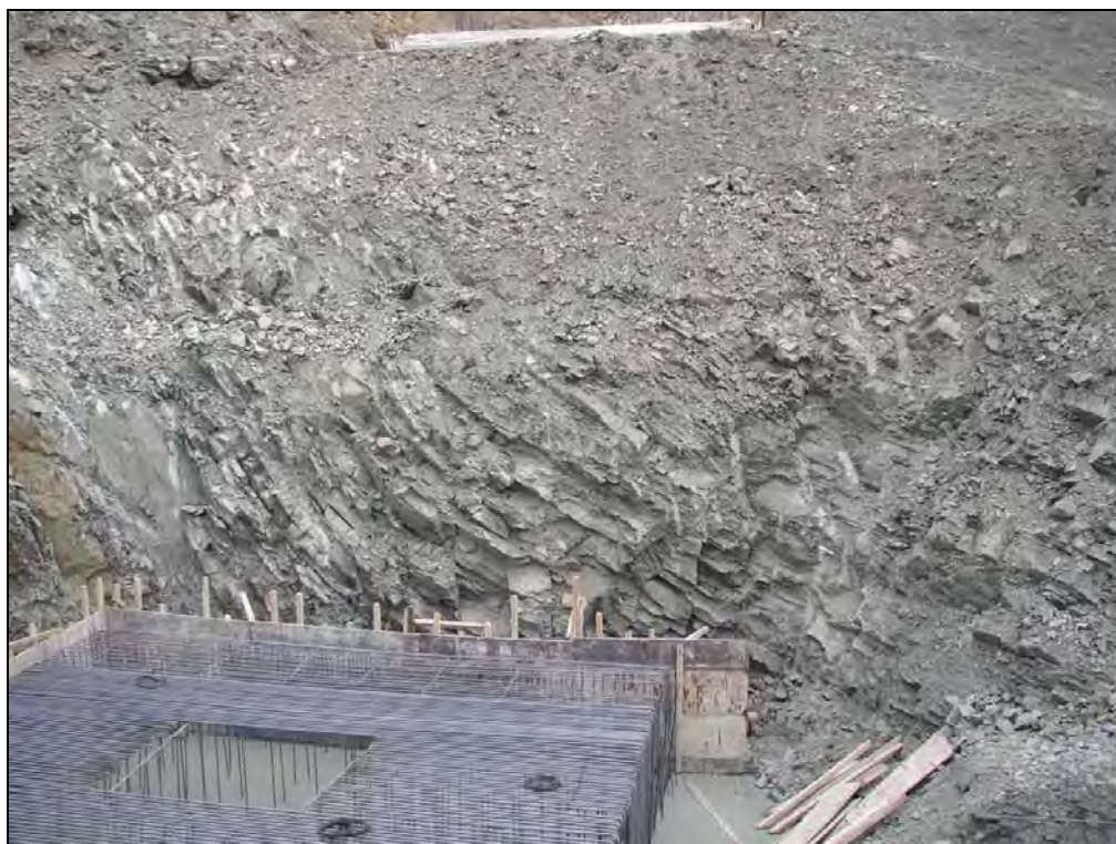
Φωτογραφία 6-9 Εμφάνιση τεκτονικής ζώνης στην περιοχή του μεσόβαθρου του τεχνικού T3. Διακρίνεται επίσης και η θέση του ακρόβαθρου. (12/07/2004)
