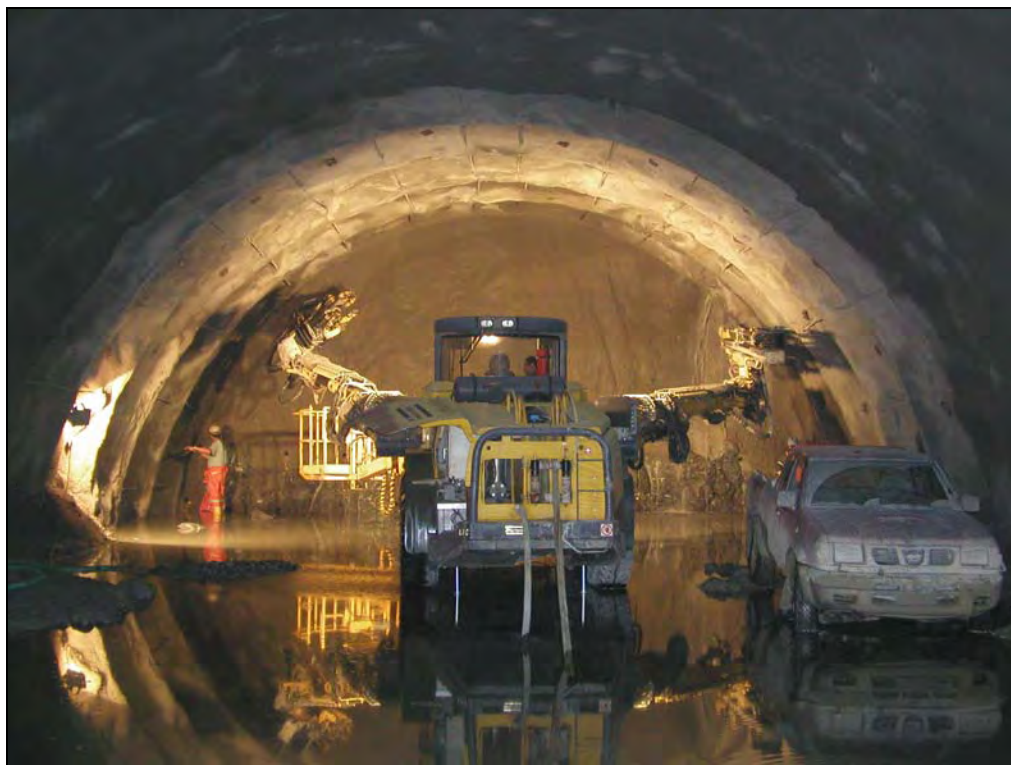
Φωτογραφία 6-21 Εργασίες διάνοιξης της σήραγγας T8 στην χ.θ. 4+900. Διακρίνεται η μεγάλη εισροή υπόγειων υδάτων (23/07/2003)
