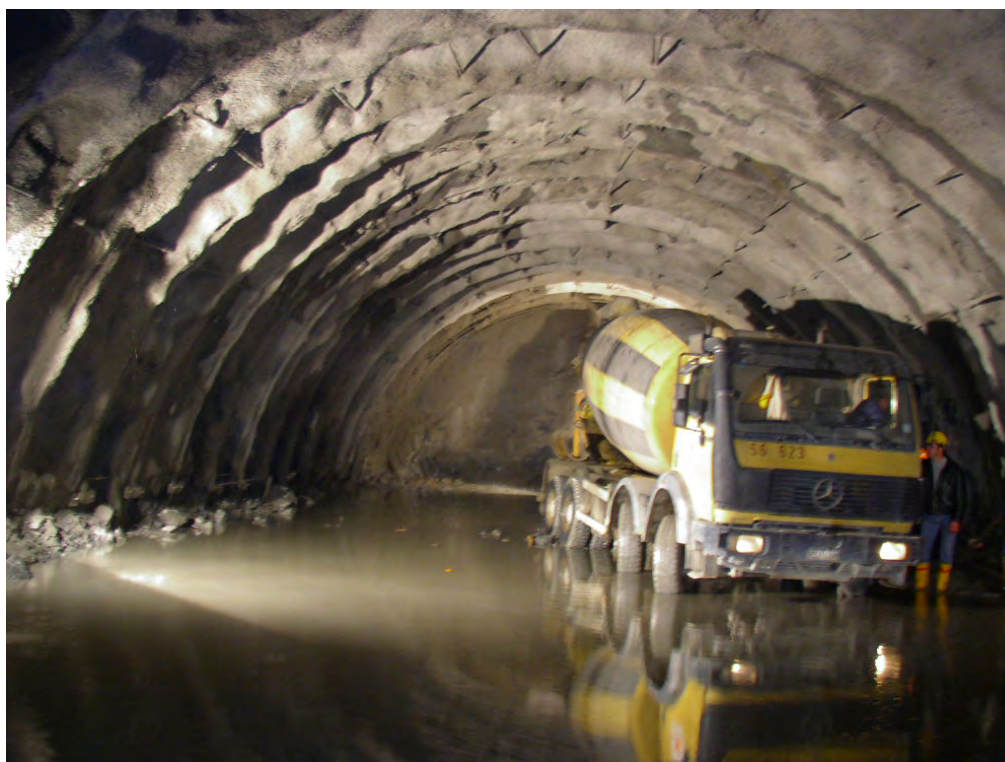
Φωτογραφία 6-19 Γεωλογική κατάπτωση στην σήραγγα T8 (χ.θ. 3+912,40) (31/10/02)
