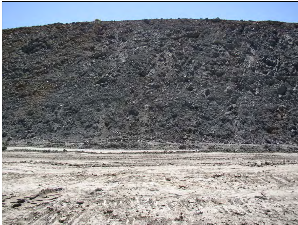
Φωτογραφία 6-3 Δεξιά όψη του ορύγματος T1, όπου διακρίνεται η πρώτη σειρά αποστραγγιστικών οπών στη μέση περίπου του δεύτερου αναβαθμού.
