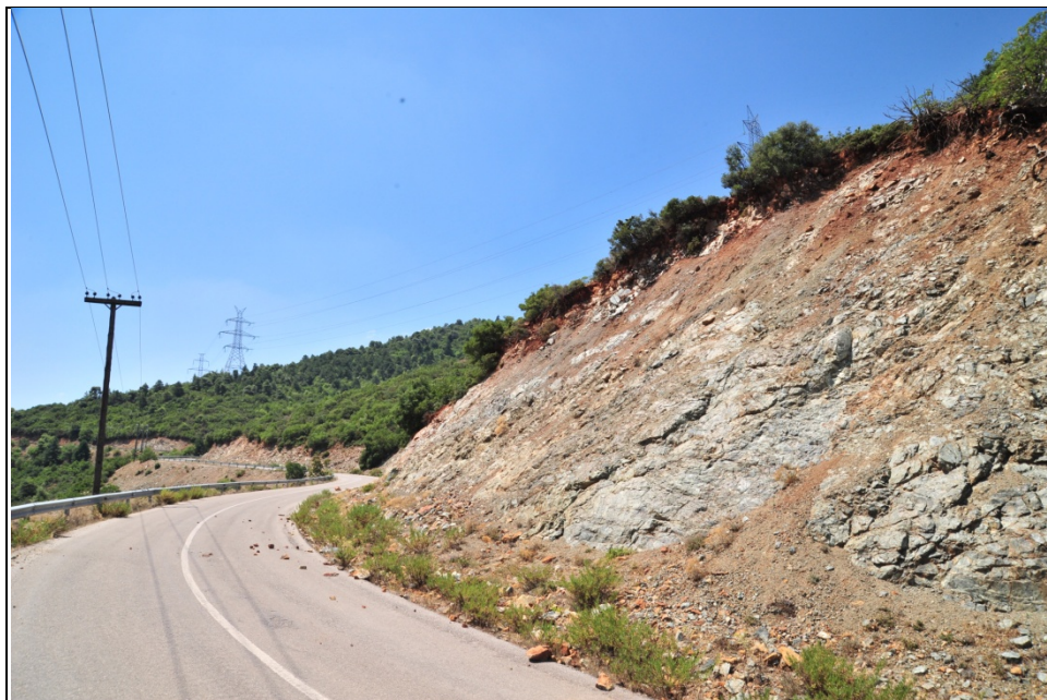
Εικόνα 3.6. Βραχοπτώσεις σε τοπικό οδικό άξονα
