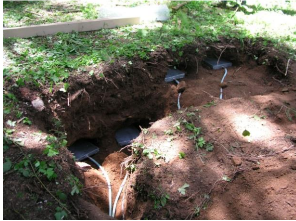
Εικόνα 7.9. Λυσιμέτρα στη Βαρετάδα.
