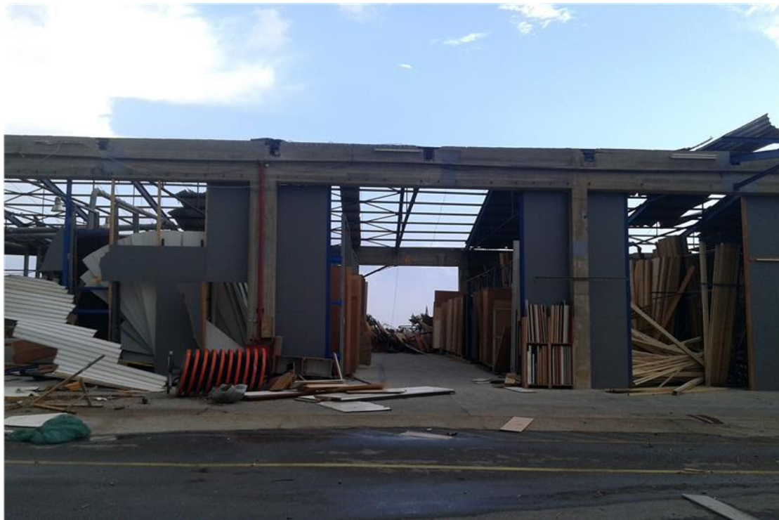
Εικόνα 5.1.3 Κατεστραμμένο εργοστάσιο στη Σκάλα Λακωνίας. Πηγή http://news.in.gr/greece/article/?aid=1500027045 Αναζήτηση στις 17/06/2016
