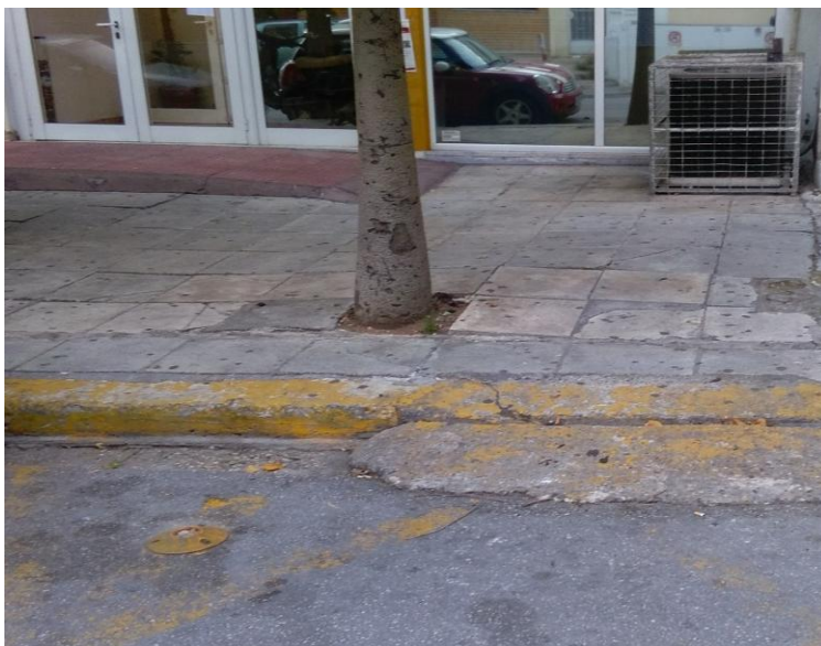
Εικ. 9: Τμήμα Δημοτικής Κατάστασης. Απουσία ειδικής θέσης στάθμευσης - ράμπα πρόσβασης ακατάλληλων προδιαγραφών
