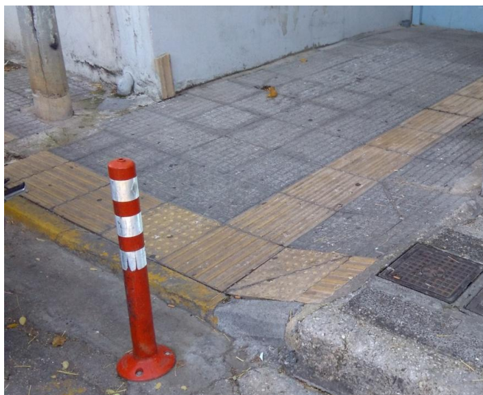
Εικ. 7: Είσοδος Τεχνικών Υπηρεσιών. Απουσία Ειδικής θέσης στάθμευσης –Απουσία ράμπας- Οδηγός τυφλών
