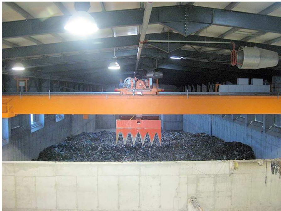
Εικόνα 2.28. Χώρος όπου πραγματοποιείται βιοξήρανση (mesogeos.gr)
