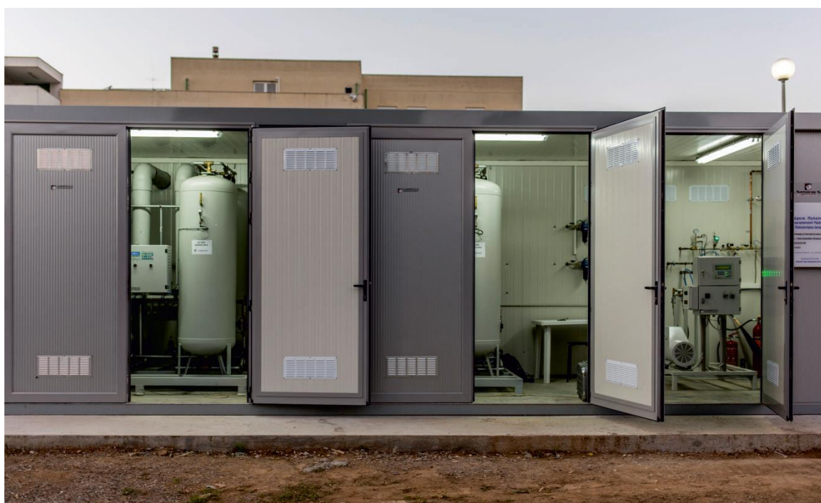
Εικόνα 5.6 Εγκαταστάσεις του πράσινου νοσοκομείου Καλαμάτας. Πηγή: B2Green (2017)
