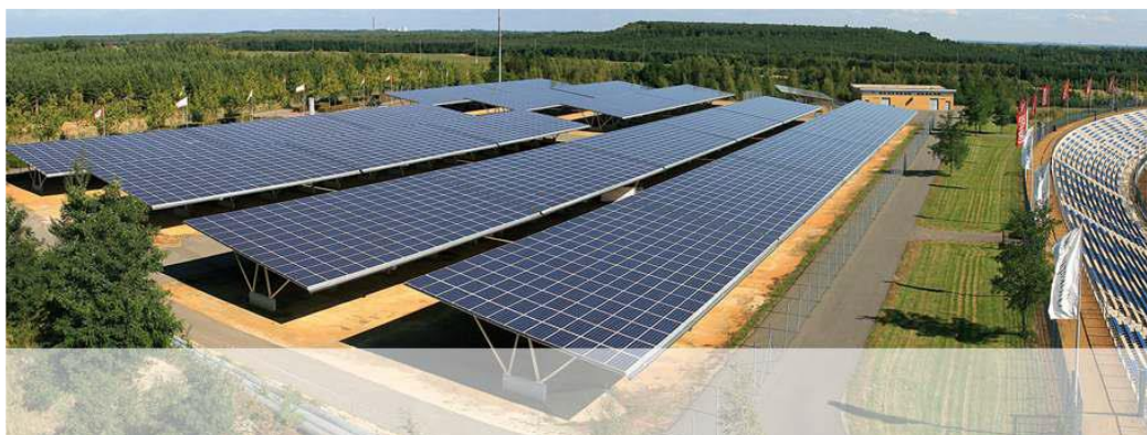
Εικόνα 5.7 Εγκαταστάσεις του πράσινου νοσοκομείου Καλαμάτας. Πηγή: B2Green (2017)
