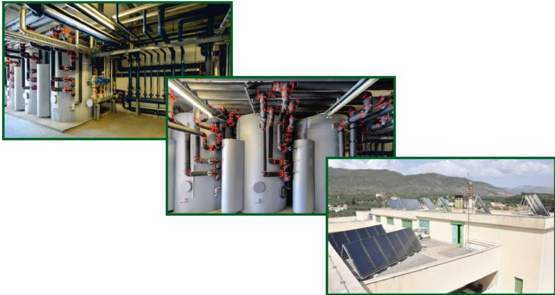
Εικόνα 5.3 Εγκαταστάσεις του πράσινου νοσοκομείου Καλαμάτας, Πηγή: B2Green (2017)
