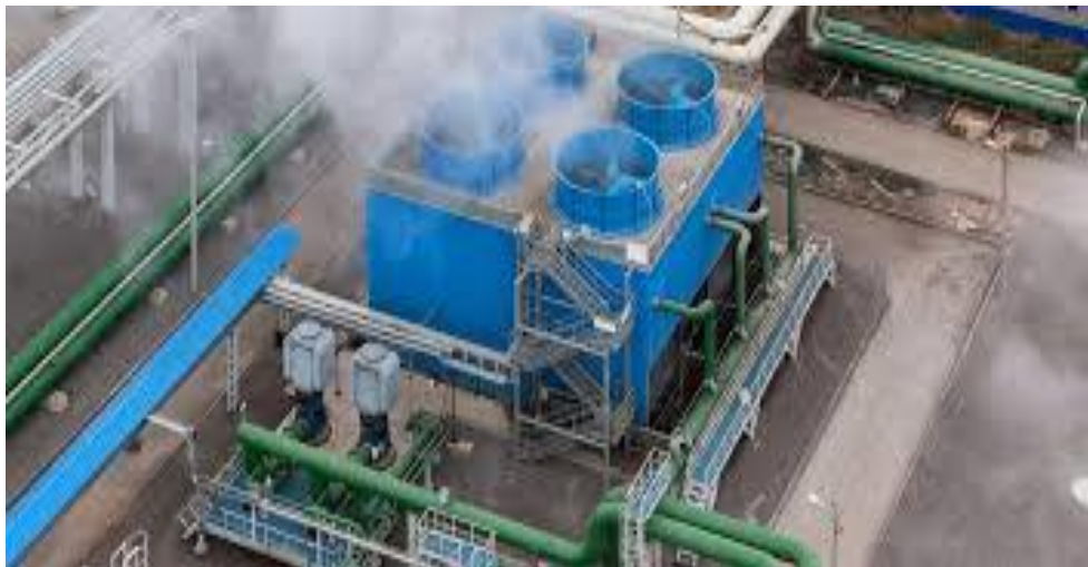
Εικόνα 21 : Σύστημα πύργων ψύξης
