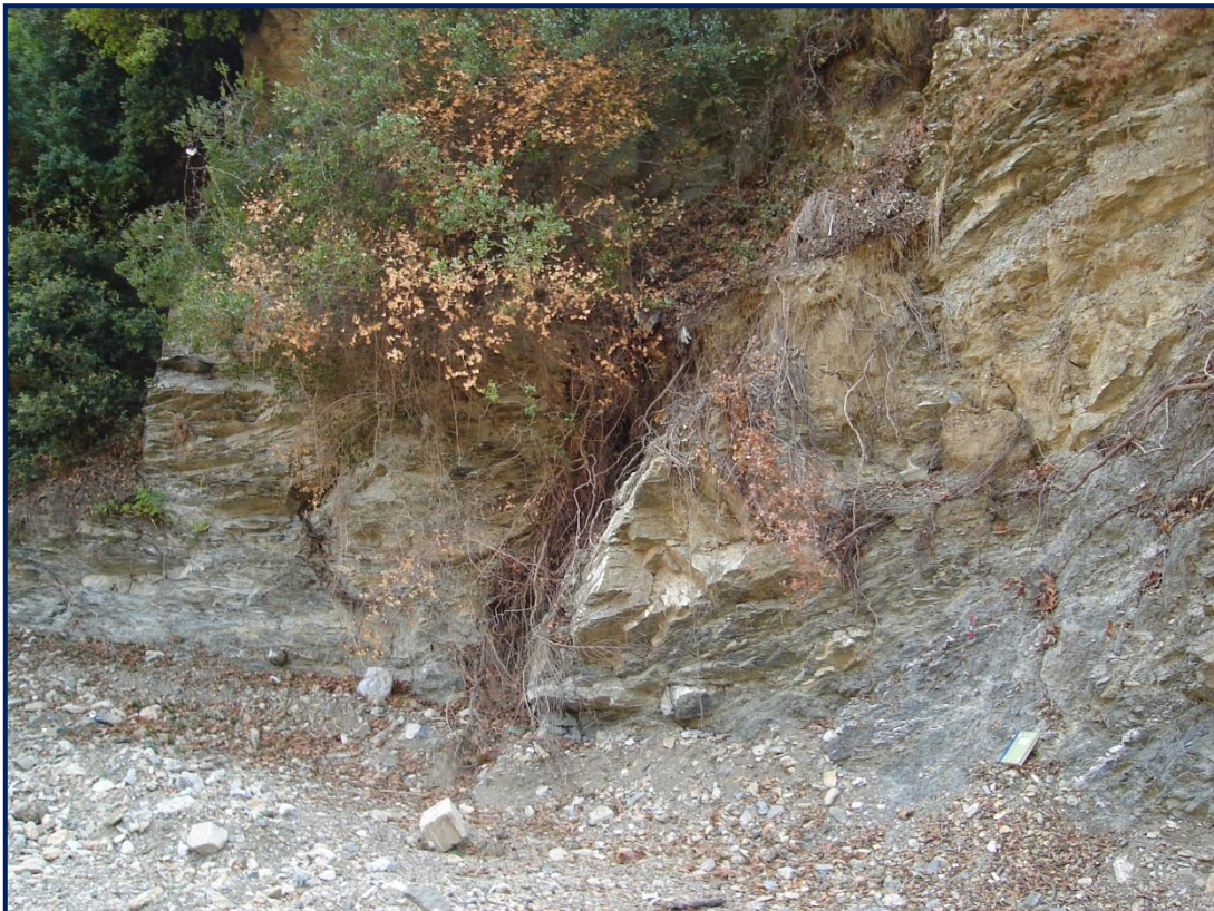
Εικόνα 45. Το ανατολικό τμήμα της εμφάνισης των προηγούμενων εικόνων. Στο κέντρο και χαμηλά, δεξιά της υδρορροής, υπάρχει ανοιχτόχρωμο συνεκτικό στρώμα με πυριτικούς κονδύλους, ενώ κάτω από αυτό έντονα φυλλωμένο πέτρωμα σκούρο γκρι. Μεταξύ τους υπάρχει επιφάνεια επαφής με στοιχεία: 33/185.
