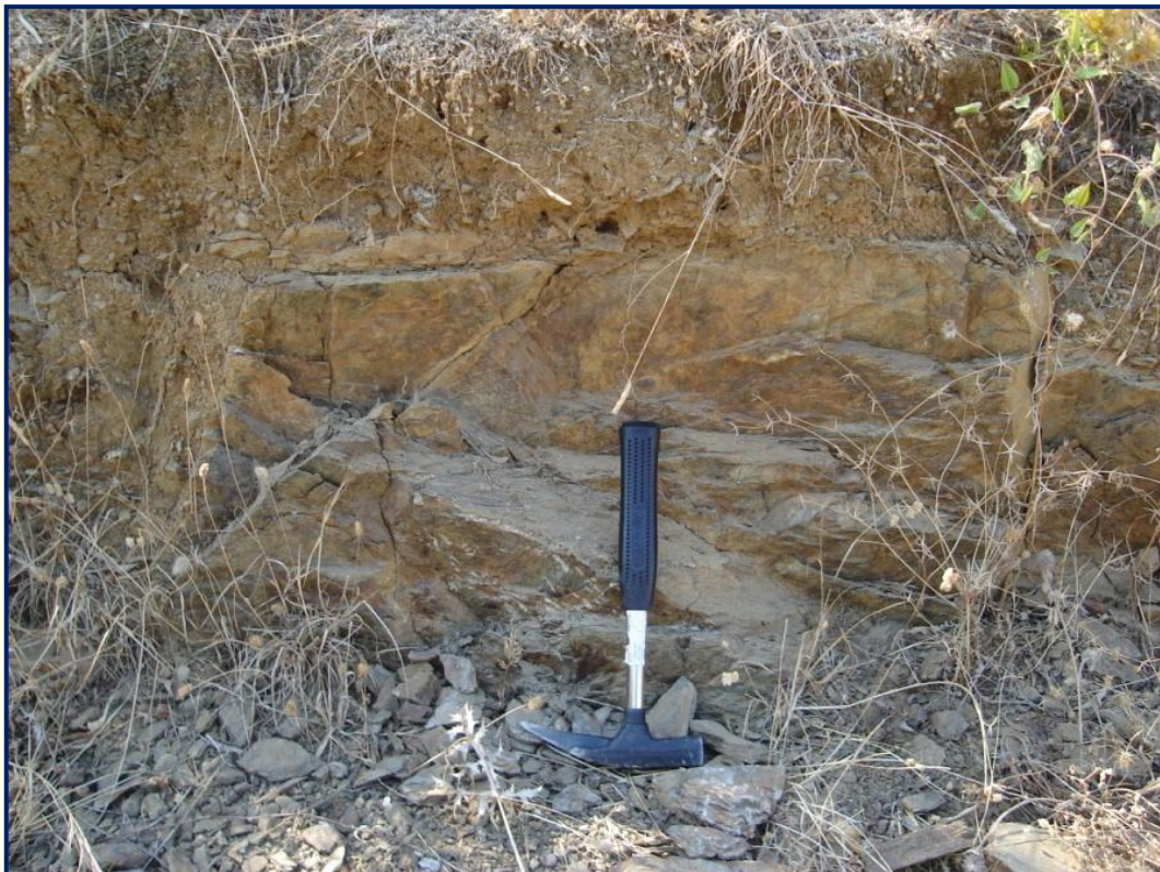
Εικόνα 21. Τομή στη νότια πλευρά αγροτικού δρόμου, 100 m περίπου νοτιοδυτικά του ογκόλιθου Κοτρωνάκι. Κάτω από τις αλλούβιες αποθέσεις διακρίνεται καταπονημένο μεταβασικό πέτρωμα που χαρακτηρίζεται από σχιστότητα. Τα στοιχεία μιας τυπικής επιφάνειας σχιστότητας στο πέτρωμα είναι 70/180. Η ακριβής θέση της εμφάνισης φαίνεται στην Εικ. 30.
