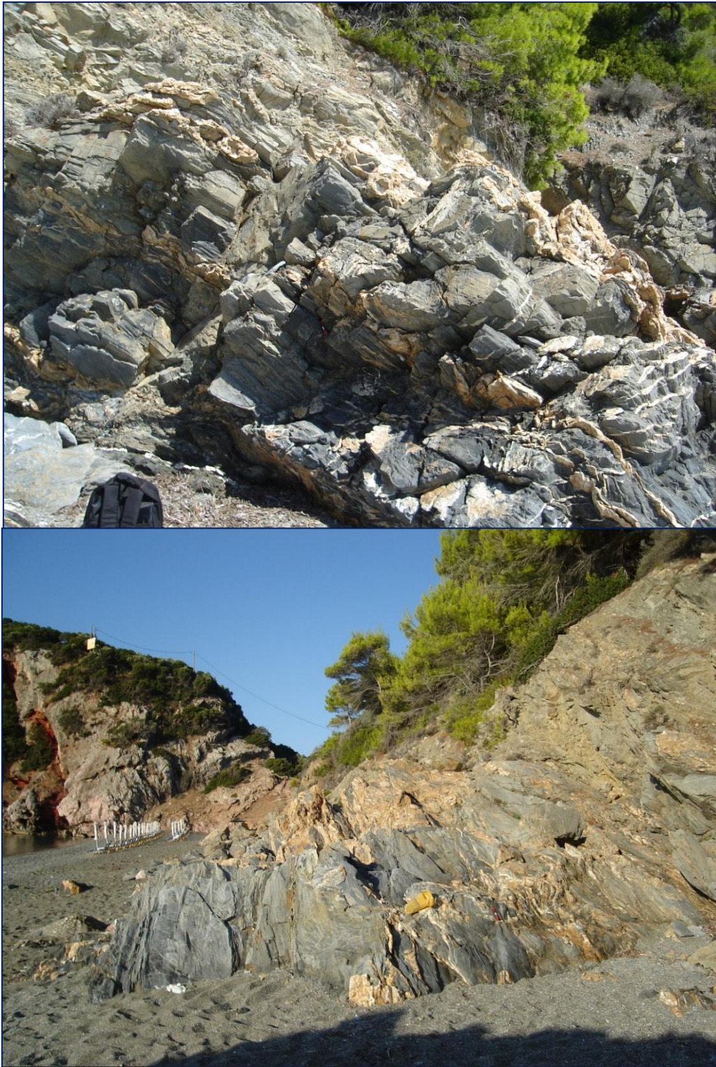
Εικόνα 102. Περίπου 15 m ανατολικά της προηγούμενης εμφάνισης πετρωμάτων, νέα εμφάνιση έντονα καταπονημένων, σχιστοποιημένων και πτυχωμένων σκληρών πετρωμάτων (η πάνω φωτογραφία εκ δυσμών, η κάτω εξ ανατολών). Χαρακτηριστικές επιφάνειες σχιστότητας έχουν στοιχεία (μ. τ. δύο μετρήσεων): 50/010.
