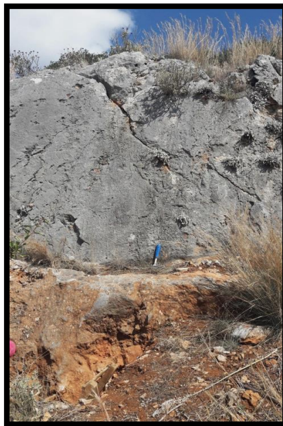
Εικόνα 25. Η κατοπτρική επιφάνεια του ρήγματος του Καπαρελλίου στην τομή Καρ3 και μέρος της παλαιοσεισμολογικής τομής.
