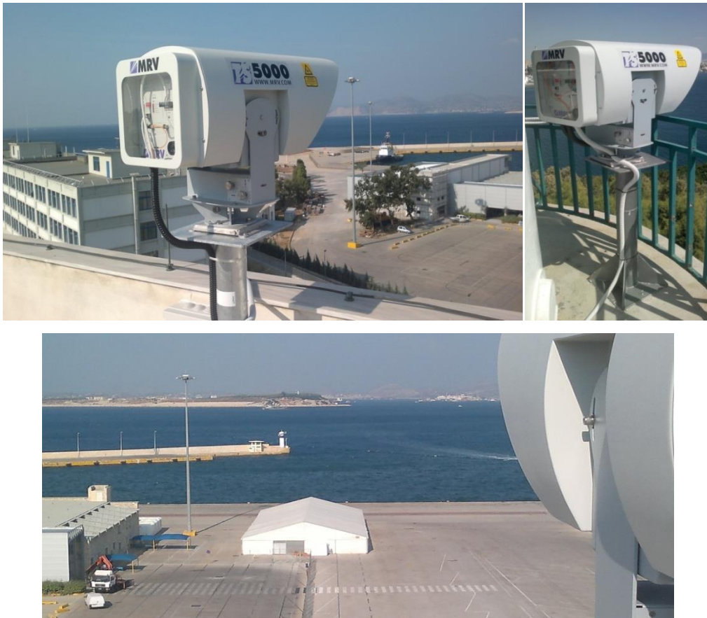
Εικόνα 4.1. Ζεύξη FSO 3 km εγκατεστημένη στη σχολή Ναυτικών Δοκίμων Πειραιά σε σύνδεση με τον φάρο στην Ψυτάλεια.
