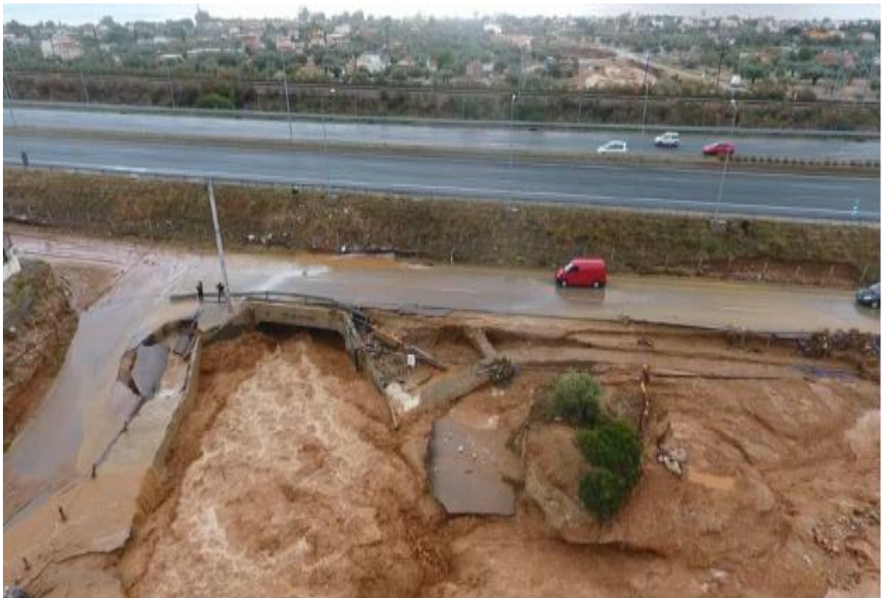
Εικόνες 5.1, 5.2: Φθορές στο οδικό δίκτυο μετά την καταστροφή στη Μάνδρα. Πηγή: (Lekkas et al, 2017)
