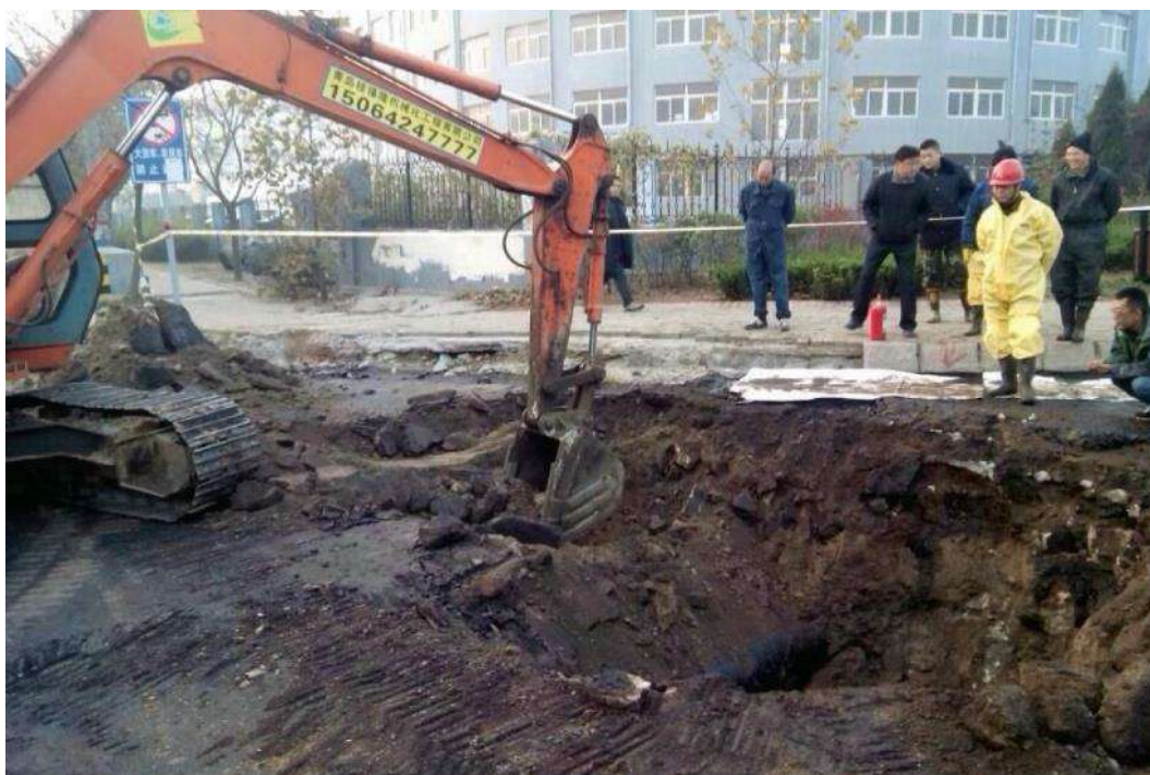
Εικόνα 2.4. Υπεύθυνοι ασφαλείας της εταιρείας Sinopec επιθεωρούν αγωγό διανομής αργού πετρελαίου στη περιοχή Qingdao, Shandong, στην Κίνα, περίπου 3 ώρες πριν την επερχόμενη έκρηξη που προκλήθηκε από διαρροή, 22 Νοε. 2013. Πηγή: Hong & Jing (2013).
