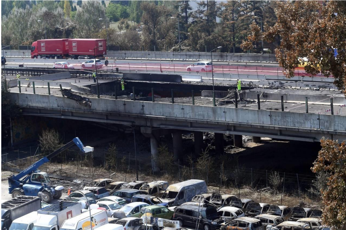
Εικόνα 5.9. Οι ζημιές στην γέφυρα του αυτοκινητόδρομου και στο πάρκινγκ αυτοκινήτων που βρισκόταν ακριβώς από κάτω (il Resto del Carlino).
