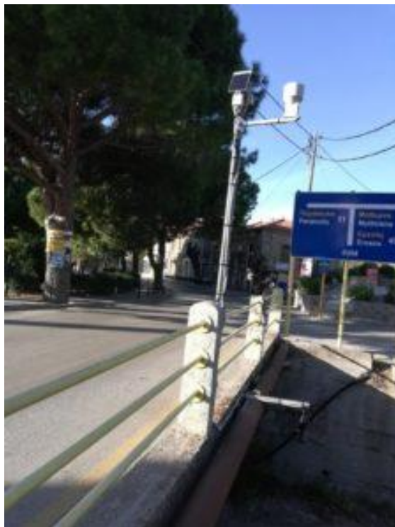
Εικόνα 3.8: Ο αυτόματος υδρομετρικός σταθμός που εγκαταστάθηκε στο πλαίσιο του έργου ERMIS-F στην κοίτη του Αχερώνα
