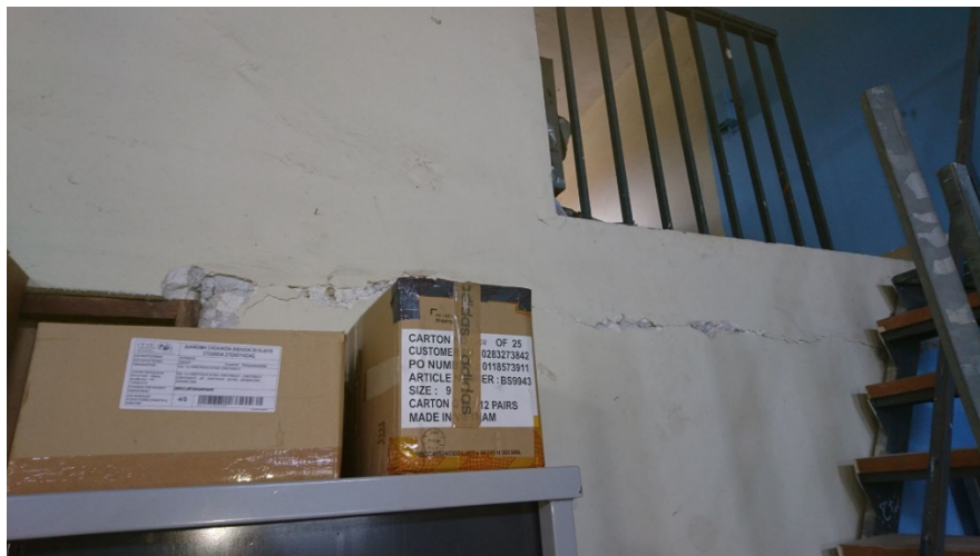
Εικόνες 117-118: ΕΠΑΛ & Ε.Κ. Ζακύνθου, Βλάβες στο κτίριο του γυμναστηρίου –Έρευνα 2 ος /2020 (Προσωπικό Αρχείο Κούτμου, 2020)
