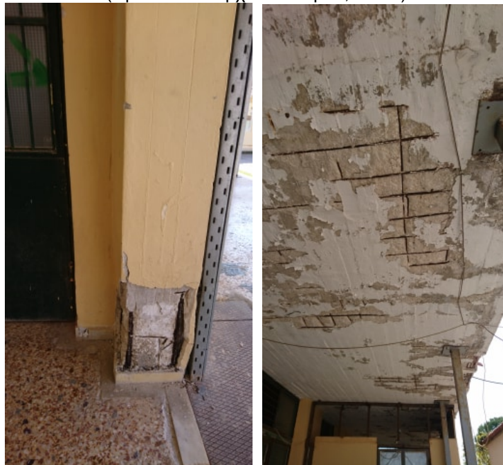
Εικόνες 119-120: ΕΠΑΛ & Ε.Κ. Ζακύνθου, Βλάβες στο κτίριο εργαστηρίων – Έρευνα 2 ος /2020 (Προσωπικό Αρχείο Κούτμου, 2020)
