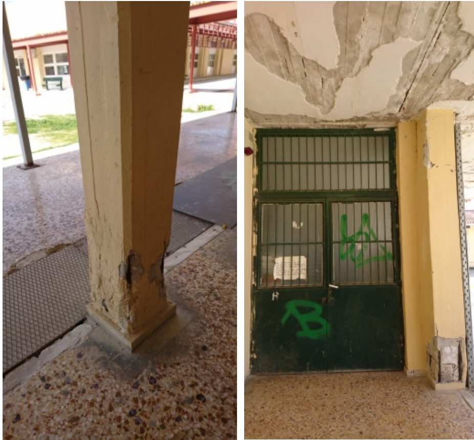
Εικόνες 121-122: ΕΠΑΛ & Ε.Κ. Ζακύνθου, Βλάβες στο κτίριο εργαστηρίων – Έρευνα 2 ος /2020 (Προσωπικό Αρχείο Κούτμου, 2020)
