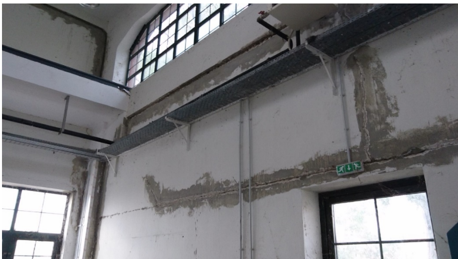
Εικόνες 55-56-57-58: ΕΠΑΛ Ληξουρίου – Το Μηχανουργείο με εκτεταμένες βλάβες σε συνθήκες εγκατάλειψης 1 ος /2020 (Προσωπικό Αρχείο Κούτμου, 2020)
