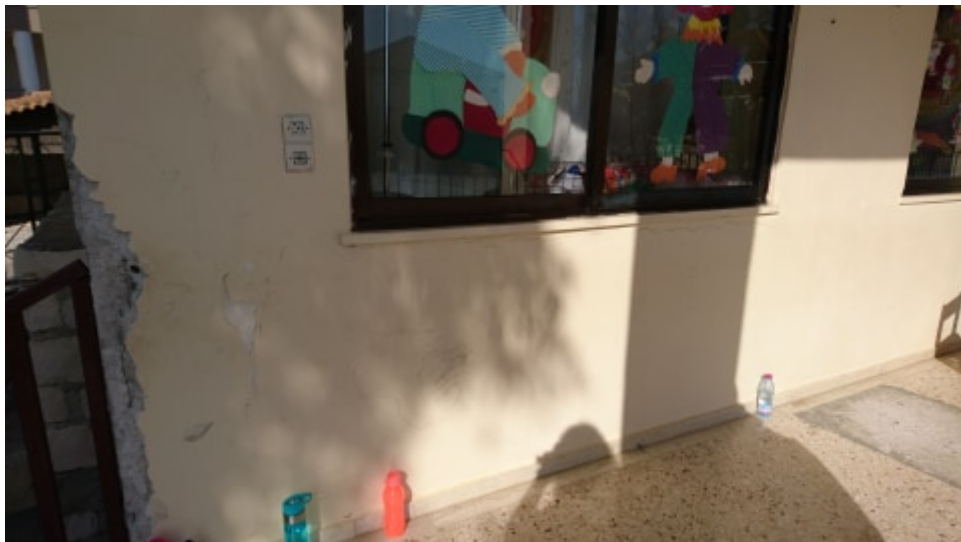
Εικόνες 94-95: Νηπιαγωγείο Αμπελοκήπων – βλάβες από το σεισμό του 2018. Έρευνα 2 ος /2020 (Προσωπικό Αρχείο Κούτμου, 2020)
