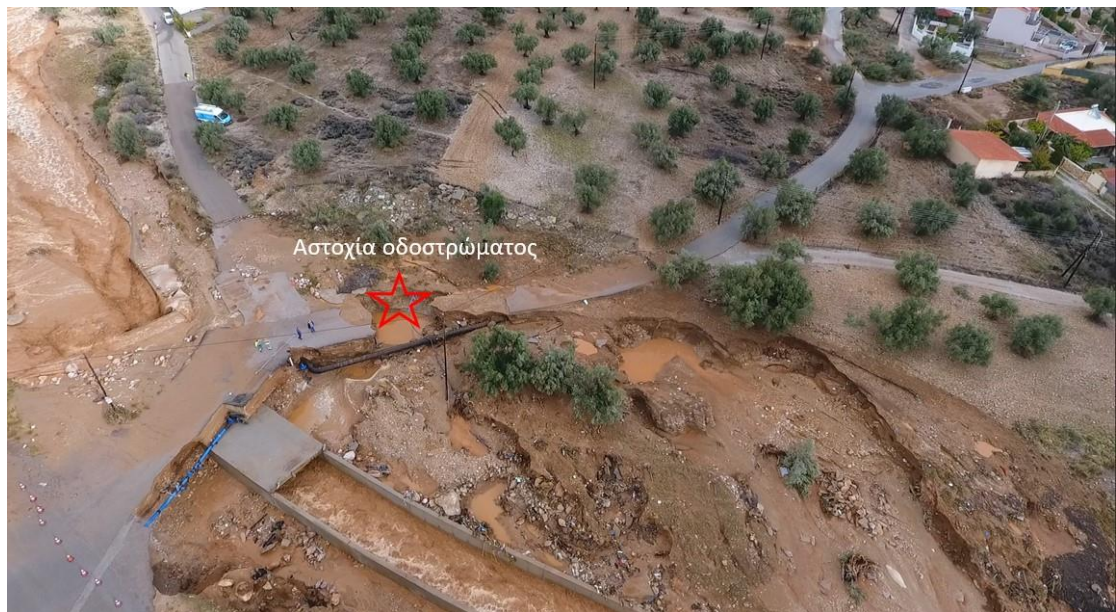
Εικόνα 2.3.9.1 : Στιγμιότυπο από βίντεο του UAV στο οποίο διακρίνεται αστοχία σε μικρή οδό, αποτέλεσμα της ορμής των υδάτων κατά τη διάρκεια της πλημμύρας.
