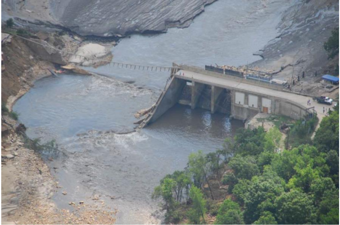
Εικόνα 1.2.5 : Αστοχία του φράγματος στη Λίμνη Delhi των Η.Π.Α το 2010. (Πηγή : https://damfailures.org/lessons-learned/high-and-significant-hazard-dams-should-be-design-to-pass-an-appropriate-design-flood-dams-constructed-prior-to-the-availability-of-extreme-rainfall-data-should-be-assessed-to-make-sure-they-have-ad/ )
