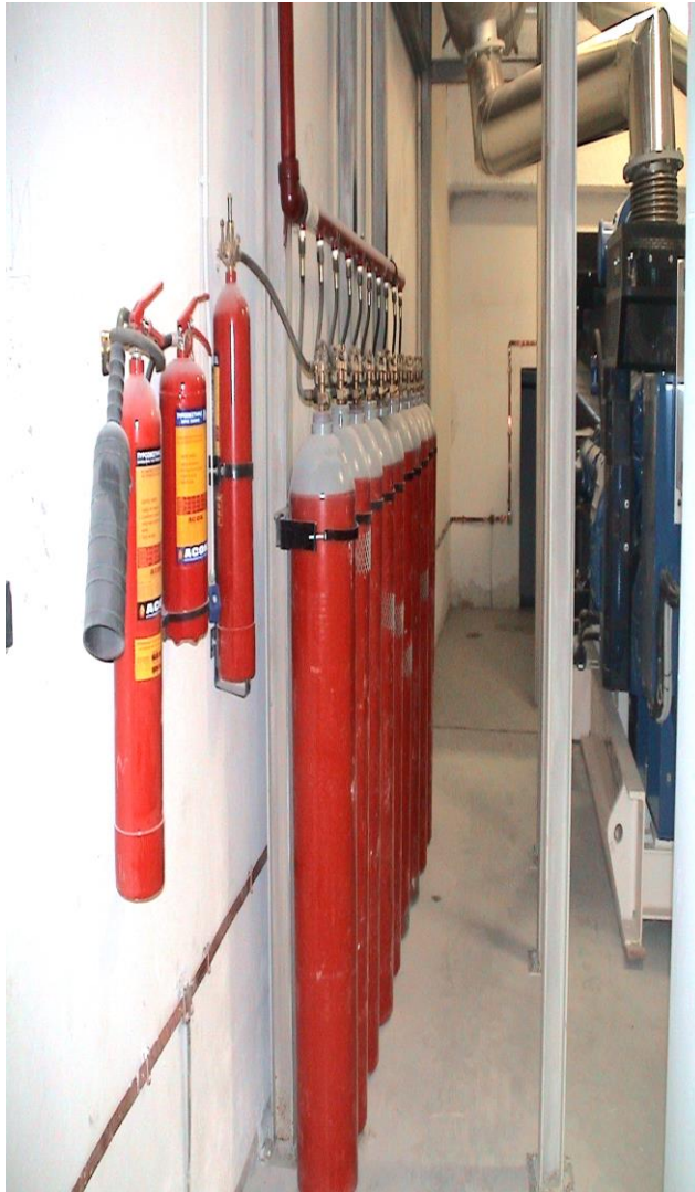
Εικόνα 2.17. Αυτόματο σύστημα πυρόσβεσης με κατασβεστικό υλικό καθαρού μέσου
