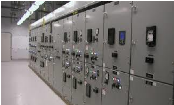
Εικόνα 2.9.Επικίνδυνος χώρος με ηλεκτρομηχανολογικό εξοπλισμό
