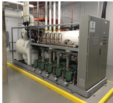
Εικόνα 2.10. Επικίνδυνος χώρος με ηλεκτρομηχανολογικό εξοπλισμό
