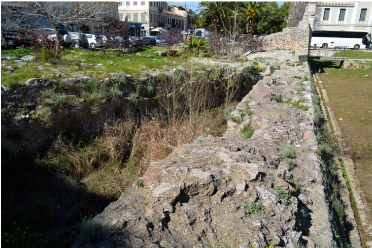
Τα τελματώδη κατάλοιπα της τάφρου και η ανεξέλεγκτη βλάστηση στην Πύλη της Ξηράς
