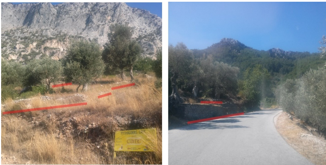
Σχήμα 4-4: Χρήση τεχνητών αναβαθμίδων στην περιοχή για τη μείωση της διάβρωσης. (α) Αριστερά βλέπουμε πέτρινα φράγματα σε άσχημη κατάσταση, (β) δεξιά βλέπουμε αναβαθμίδες σε καλή κατάσταση
