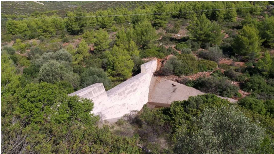
Σχήμα 4.19: Αντιπλημμυρικό έργο (φράγμα) στο σημείο παρατήρησης 24
