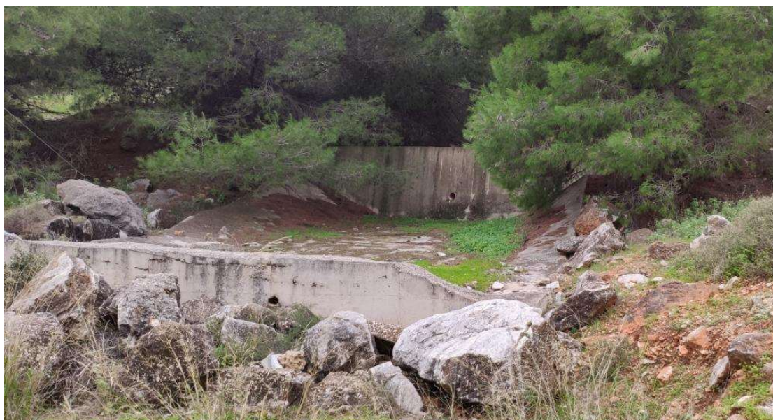
Σχήμα 4.17: Αντιπλημμυρικό έργο (φράγμα) στο σημείο παρατήρησης 23.
