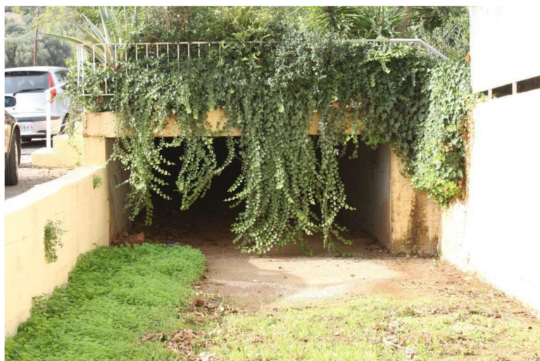
Σχήμα 4.12: Αγωγός αποστράγγισης μεγάλης διατομής στο σημείο παρατήρησης 19
