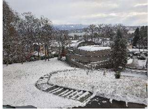
Εικ. 30. Ελβετία. Γενεύη. Άγιος Παύλος, η ΒΔ πλευρά. Διακρίνονται η στέγη με τις υδρορροές, μαζί με τον τρούλο ως ελλειψοειδή βούτα, (Προσωπικό αρχείο).
