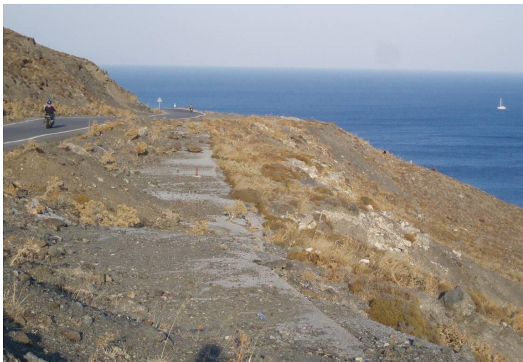
Εικ. 1.10 Καθίζηση του οδοστρώματος στην επαρχιακή οδό Αγ. Φωκάς – Θερμά.
