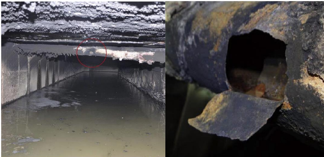
Εικόνα 3.3 Αριστερά: Φωτογραφία του μικρού αγωγού (4"). Δεξιά: Το σημείο διάρρηξης του αγωγού. Πηγή: (Chen et al., 2016).
