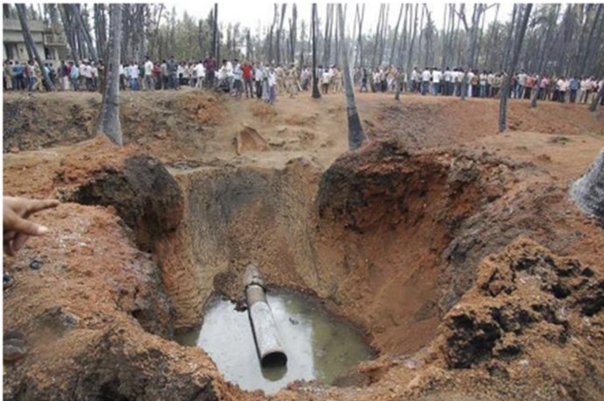
Εικόνα 3.4 Ο κρατήρας που δημιουργήθηκε από την ολική διάρρηξη του υπερσυμπιεσμένου αγωγού. Πηγή: (Mishra & Wehrstedt, 2015).
