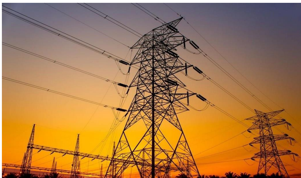
Εικόνα 2.1 Γραμμές Μεταφοράς Ηλεκτρικής Ενέργειας
