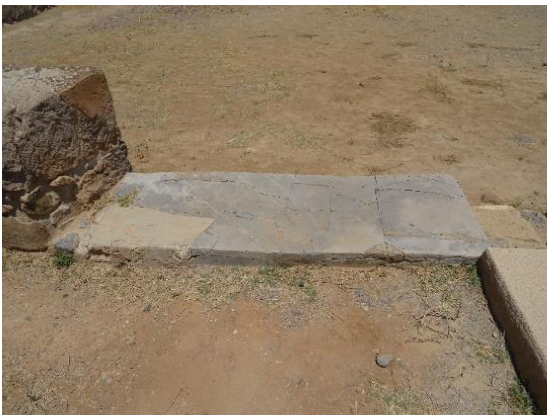
Εικόνα 8.20: Θραύσεις και ρηγματώσεις παλαιών κονιαμάτων.
