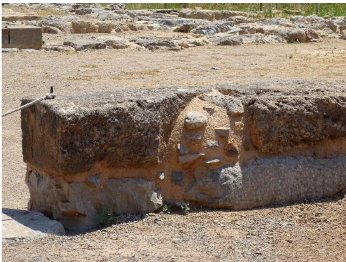
Εικόνα 8.24: Συμπλήρωση λίθινου στοιχείου με αδόκιμο τρόπο.
