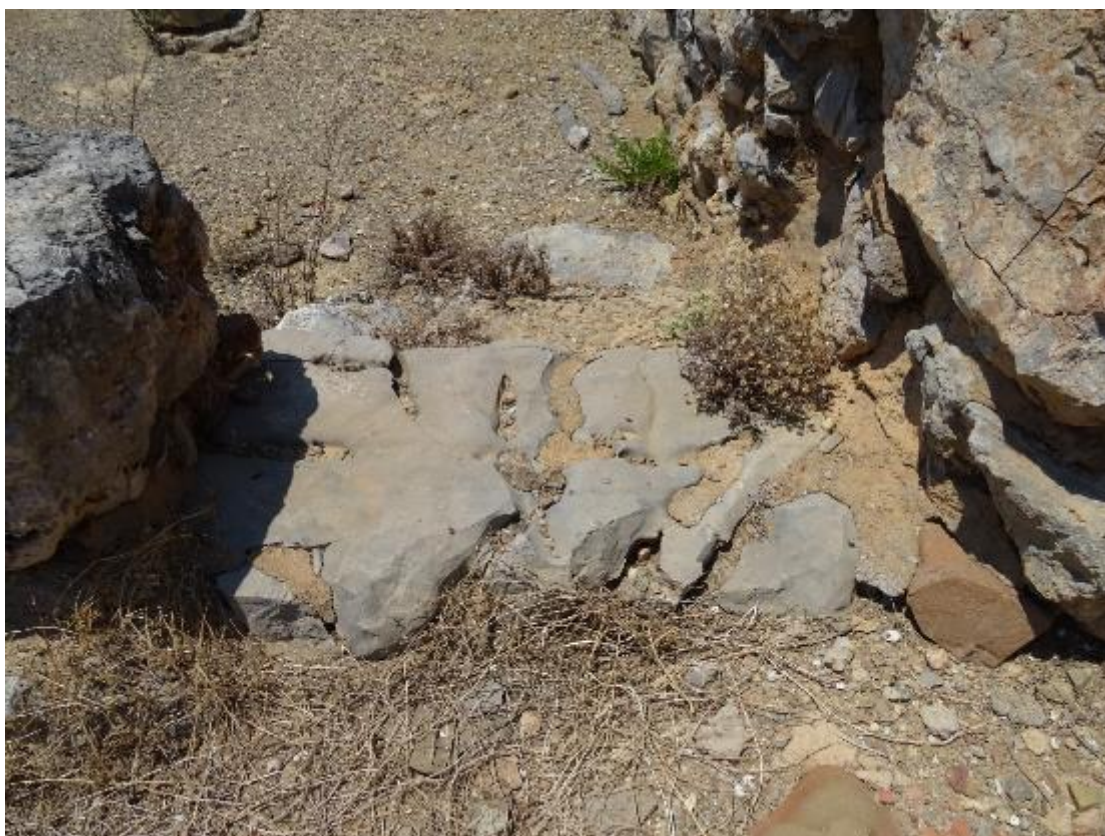
Εικόνα 8.21: Θραύσεις και ρηγματώσεις παλαιών κονιαμάτων.
