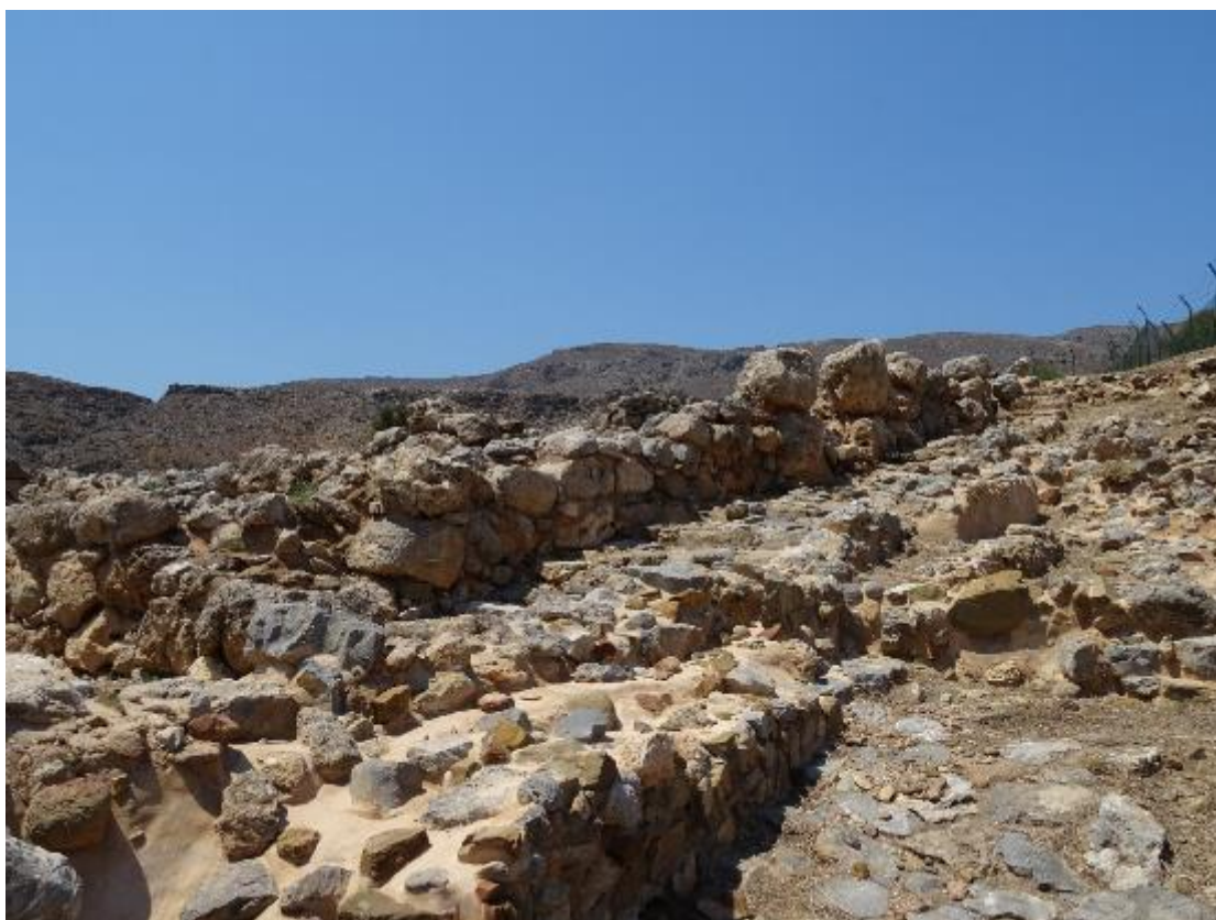
Εικόνα 8.26: Αλλοίωση αργολιθοδομής και μορφολογίας κτηρίου.
