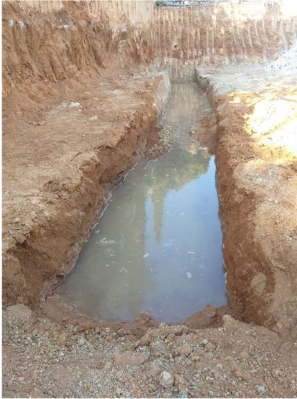
Εικ. 6.1 : Εισροή υδάτων κατά την εκσκαφή
