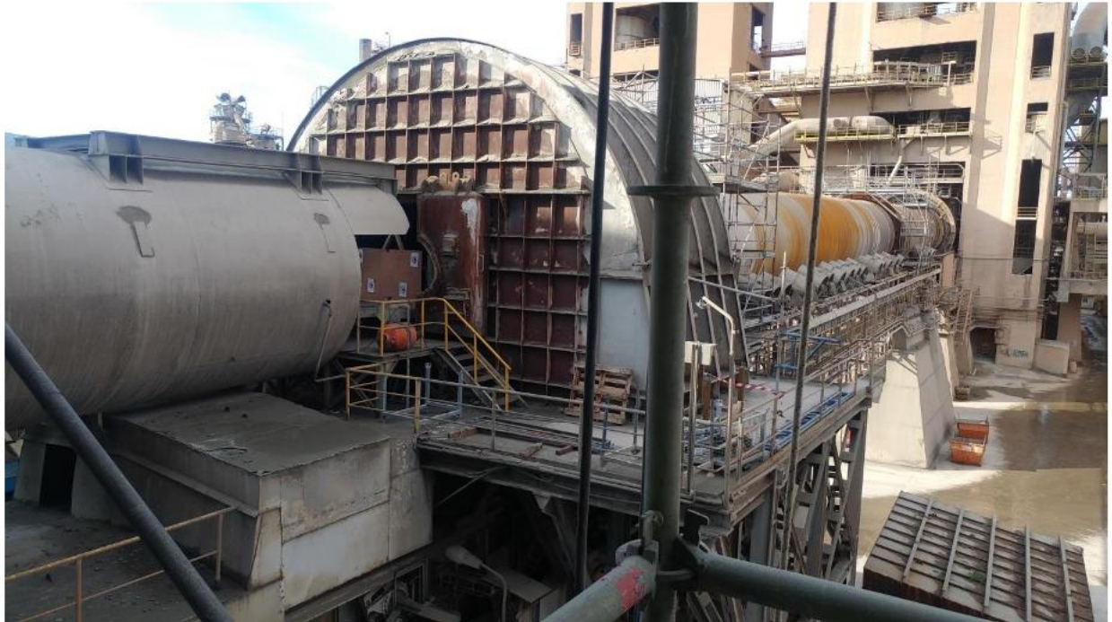
Εικόνα 19: Εργοστάσιο Καμαρίου - Ο περιστροφικός κλίβανος εξωτερικά. Κατά μήκος αυτού υπάρχουν συστήματα αερισμού για να κρατούν ισορροπία μεταξύ εσωτερικού και εξωτερικού περιβάλλοντος.
