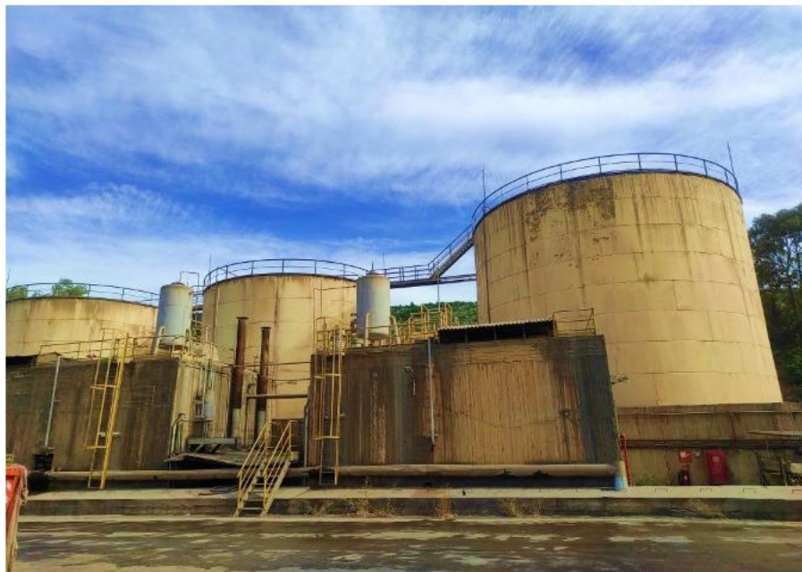
Εικόνα 59: Δεξαναμενές αποθήκευσης μαζούτ
