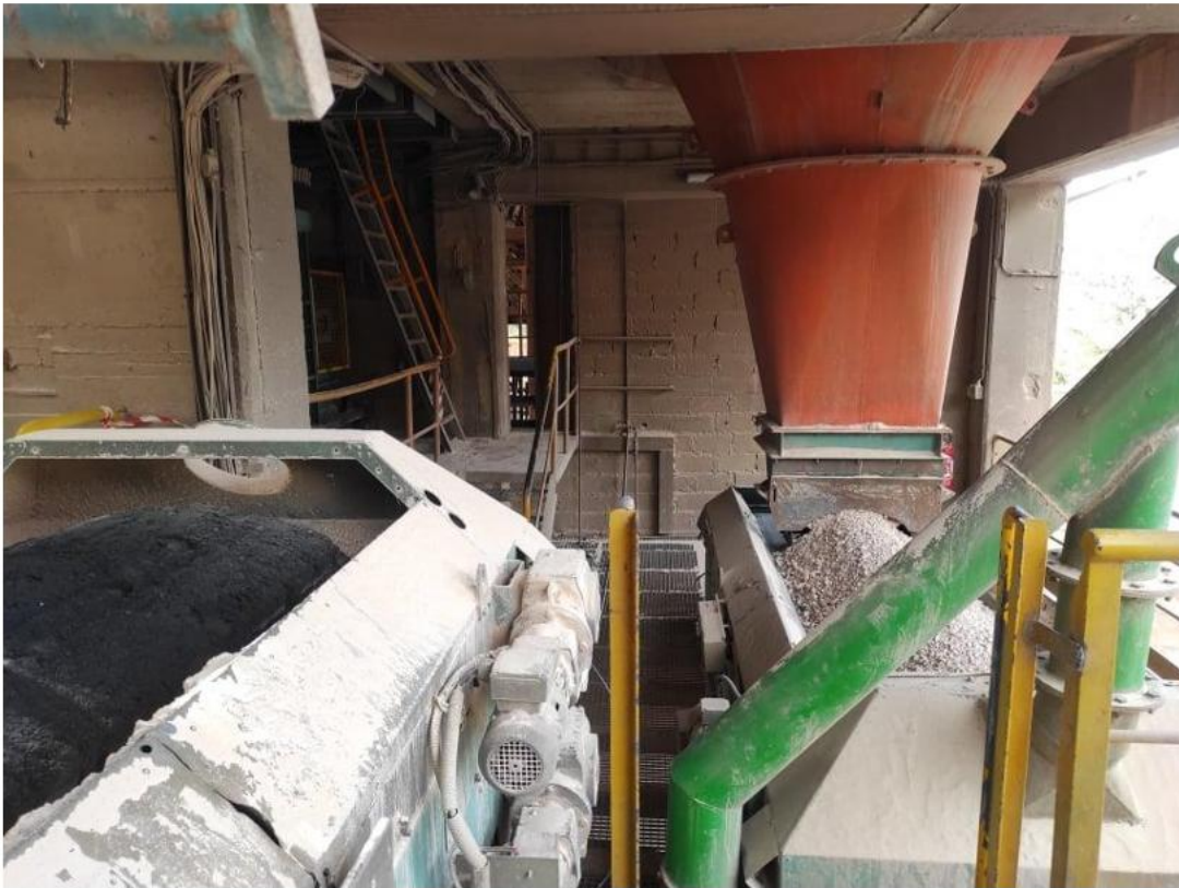
Εικόνα 10: Εργοστάσιο Καμαρίου - Τροφοδότης ασβεστολίθου στο βάθος και αριστερά, τροφοδότης Iron Silicate
