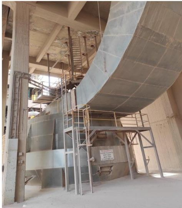
Εικόνα 14: Σύστημα Διαχωριστή, Εργοστάσιο Καμαρίου
