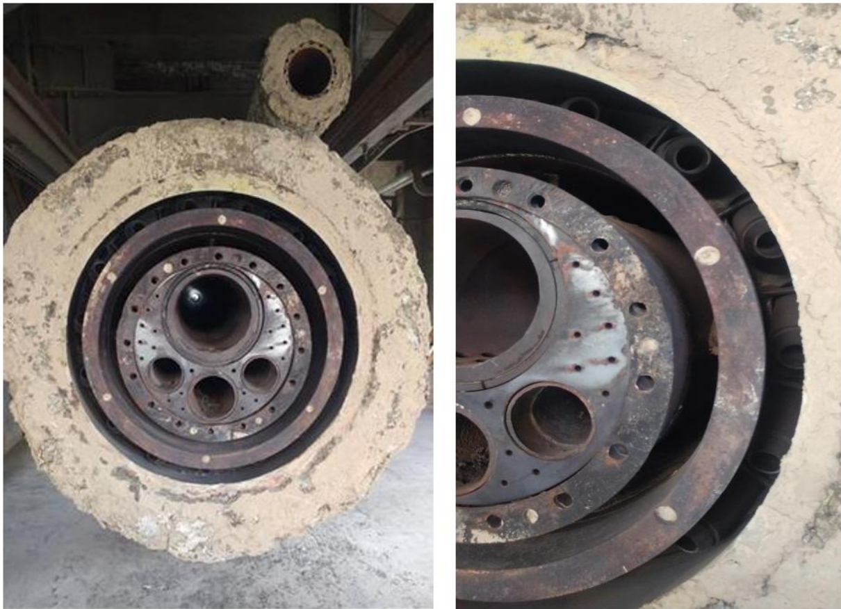
Εικόνα 18: Εργοστάσιο Καμαρίου - Αριστερά: Φωτογραφία burner, λίγο πριν την συντήρηση. Από τις διαφορετικές οπές τροφοδοτούνται διαφορετικών ειδών καύσιμα. Δεξιά: Παροχή στροβιλιζόμενου αέρα.
