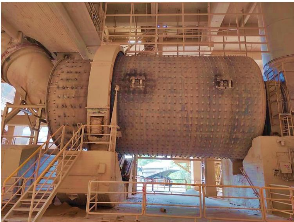
Εικόνα 11: Σφαιρόμυλος, Εργοστάσιο Καμαρίου
