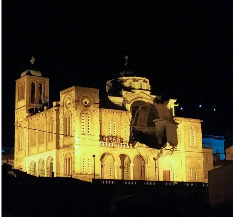
28. Ο Ι. Ναός Κοιμήσεως Θεοτόκου στο Καρλόβασι Σάμου χτυπημένος από το σεισμό της 30.10.2020 (Αρχείο της Τοπογράφου Μηχ/κού Υπαλλήλου ΤΑΕΦΚ-Α.Α. Μαρίας Τσέρμου)
