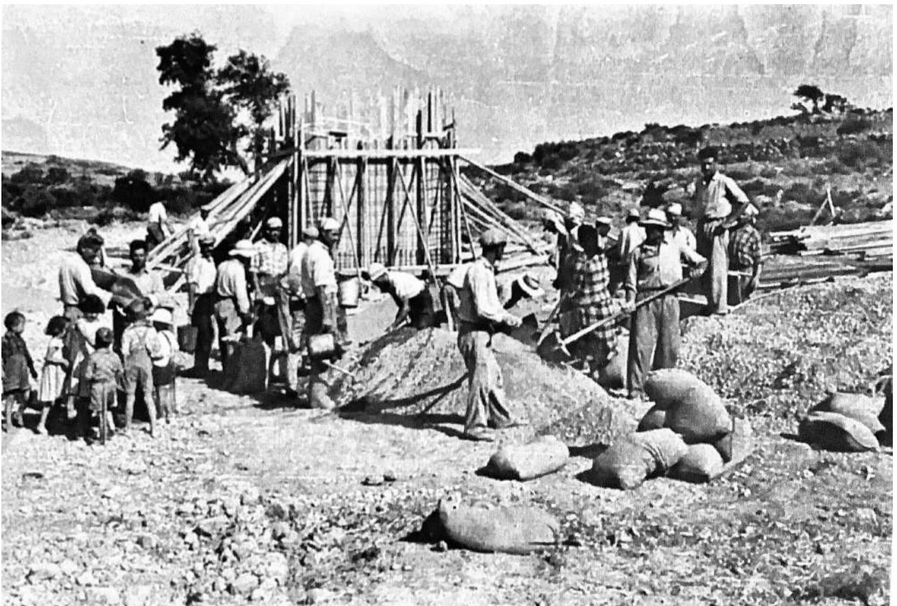
Εικόνα 34. Κατασκευή δεξαμενής νερού στον Κάμπο της Ιεράπετρας στις αρχές της δεκαετίας του 1960 [Πηγή: Πολιτιστικός Φυσιολατρικός Σύλλογος Ανατολής]
