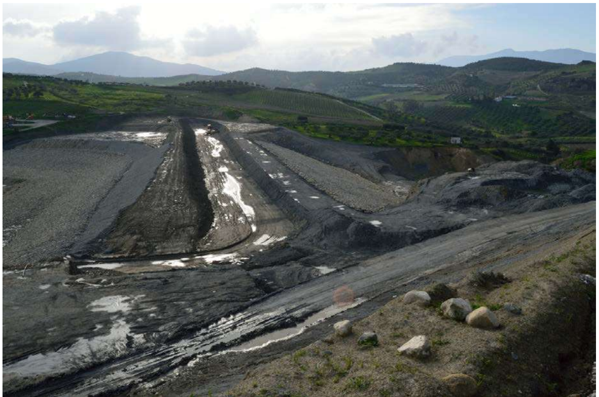
Εσώφυλλο β΄: Η θέση του Φράγματος του Χαλαυριανού Χειμάρρου στην περιοχή νοτιοδυτικά του ΥΜΙ Βαθυπέτρου, στον γεωλογικό Σχηματισμό Βιάννου (κεφάλαιο 3, υποκεφάλαιο 3.4.β.ii., 3.7.β.), όπου εντοπίζεται μεγάλη ποσότητα ποταμολιμναίων, σκούρων τεφρών αργίλων (λήψη γράφουσας, προς δυτικά, 20.01.2014, κατά την κατασκευή του φράγματος).
