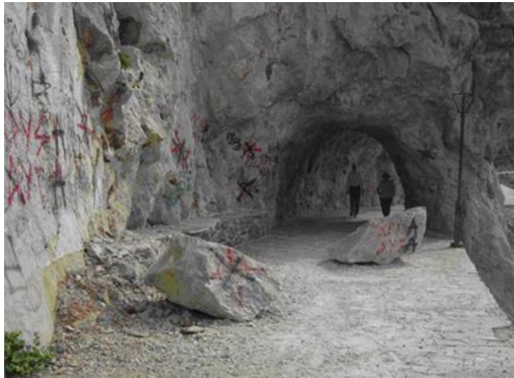
Εικόνα 1.3 Καταπτώσεις βραχωδών μαζών στο μονοπάτι της Αρβανιτιάς έπειτα από το γεγονός του Ιανουαρίου 2010 (Κωνσταντοπούλου κ.ά., 2010).
