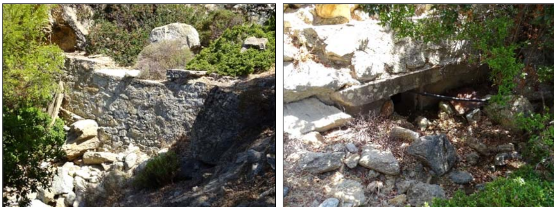
Εικόνα 8-11: Άποψη των έργων υδρομάστευσης στην πηγή Επάνω Δέσης (S01).
