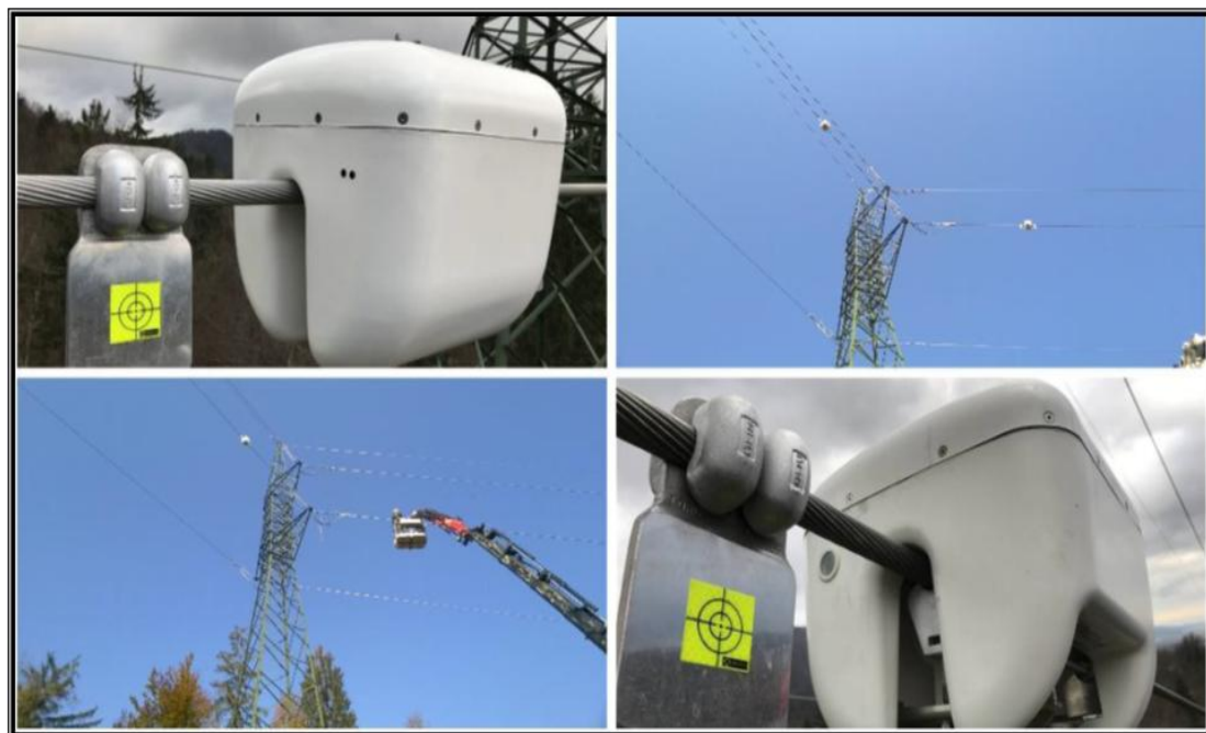
Εικόνα 20: Εγκατάσταση συσκευών OLTM στη γραμμή μεταφοράς Kleče – Logatec
