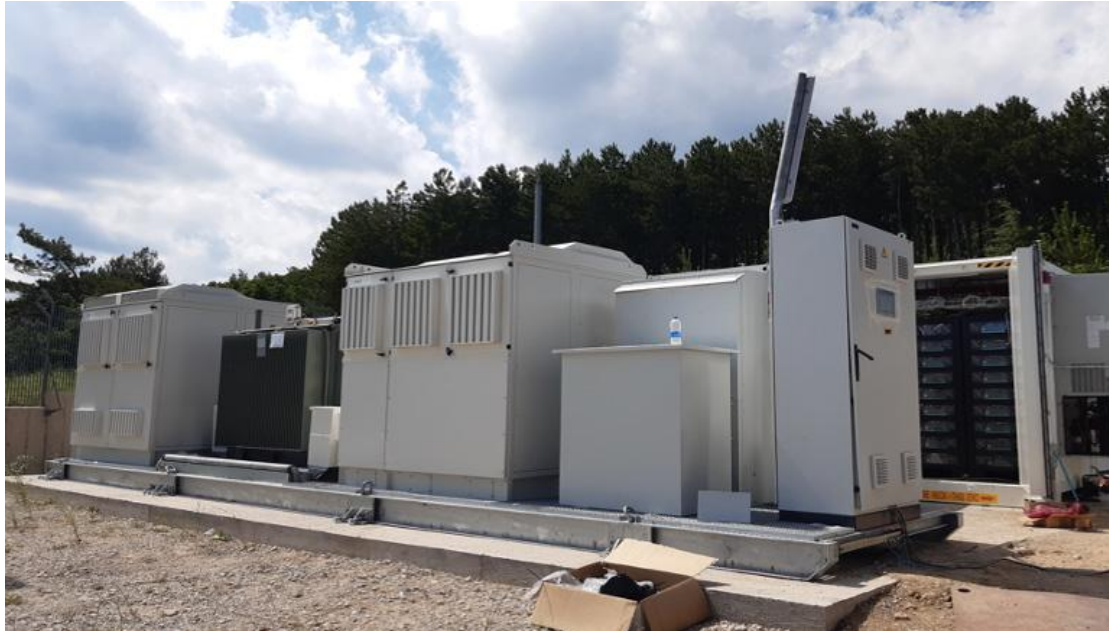
Εικόνα 40: Σύστημα αποθήκευσης ηλεκτρικής ενέργειας εγκατεστημένο στον Υ/Σ Αισύμης, [35]
